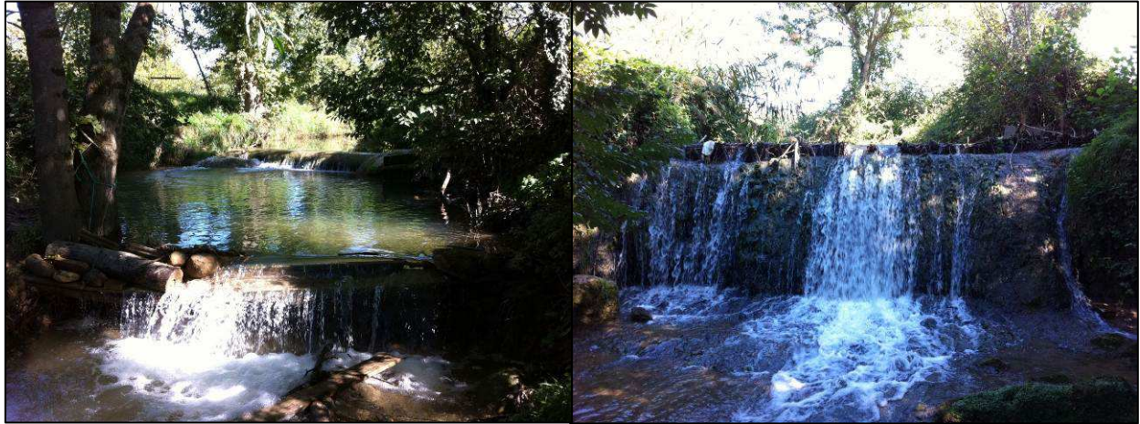
Fig.23 : Seuil de la soufflerie (image de gauche,) et seuil du Bia (image de droite), représentant un point de blocage à la continuité écologique et sédimentaire. ( Source : GREN, Septembre 2011).
