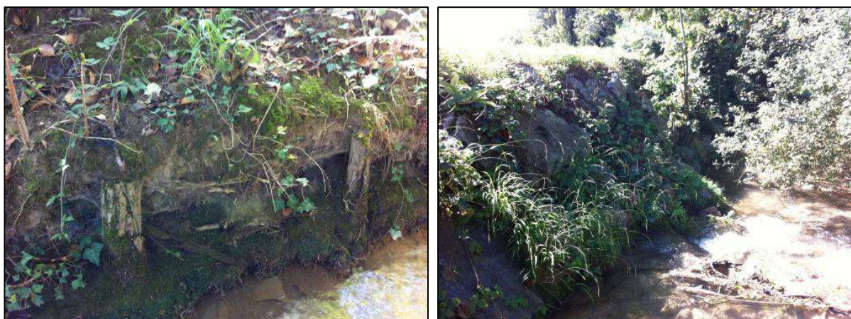
Fig.22 : Illustrations des protections de berges mis en place dans le but de protéger les zones à enjeux : anciens tunage bois (image de gauche) et enrochement permettant le soutènement de la route présente en rive gauche (image de droite). ( Source : GREN, Septembre 2011).
