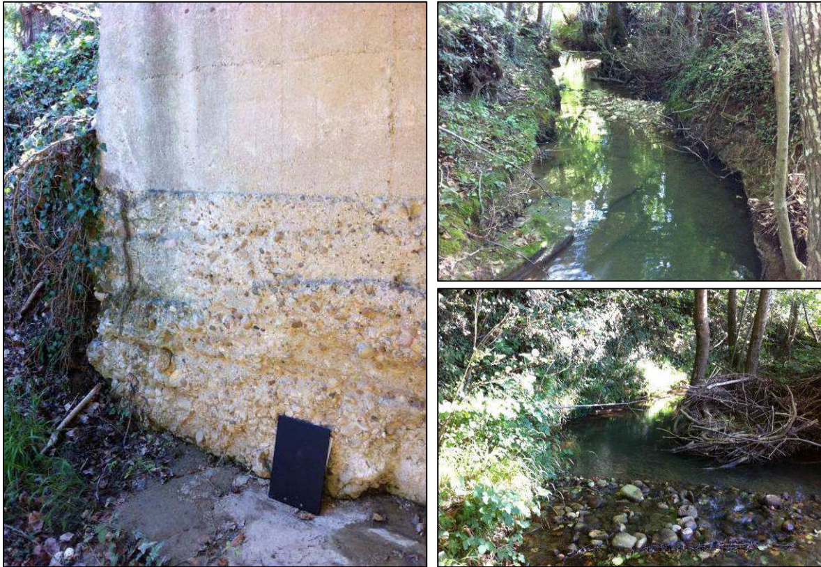
Fig.06 : Illustrations des phénomènes d'incision observés lors des investigations de terrains. Image de gauche, pile de pont marqué par ce type de processus, image en haut à droite système racinaire apparent. En bas à droite, phénomène d'érosion latérale en amont d'une souche d'aulne, favorisant la création d'habitat attractif pour les biocénoses aquatiques. ( Source : GREN, Septembre 2011).
