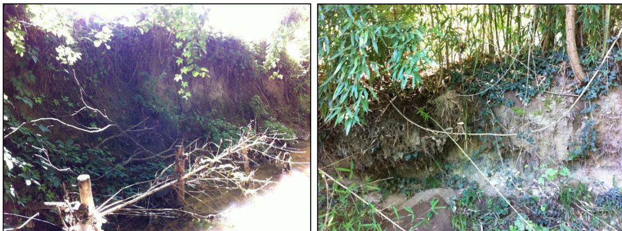
Fig.21 : Illustrations des phénomènes d'érosion latérale observés en berges : vestige de protections type pieux bois (image de gauche) et végétation inadaptée à la tenue mécanique des sols (espèce ornementale type bambous) favorisant ces phénomènes. ( Source : GREN, Septembre 2011).
