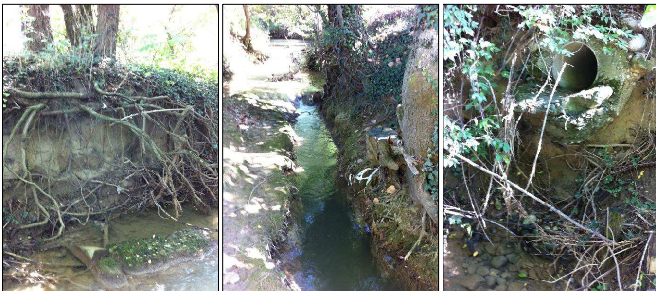
Fig.20 : Illustrations des phénomènes d'incision de berge observés sur le linéaire considéré. Systèmes racinaires apparents (image de gauche), incision du lit (image centrale) et rejet d'eaux pluviales affouillé (image de droite). ( Source : GREN, Septembre 2011).
