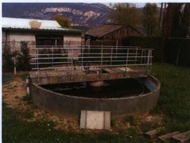
Figure 25 : Clarificateur de l'usine de dépollution de Conjux (Source : VEOLIA, 2010)
