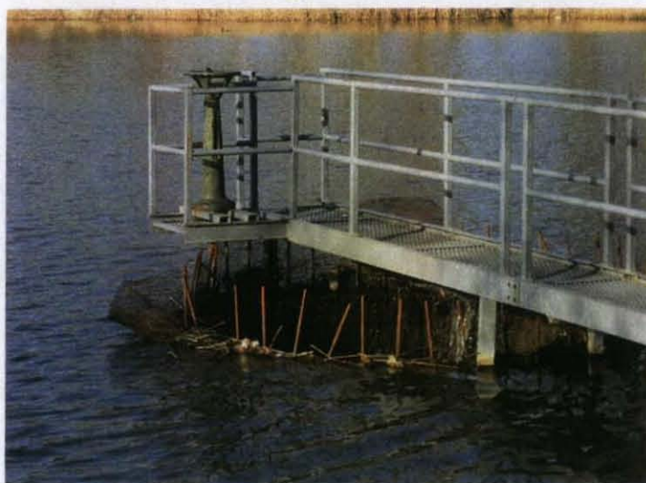
Buse de déversement du trop-plein (D= 3 m)
