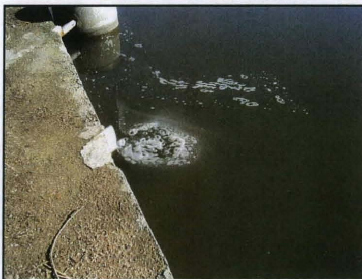
Point de rejet de la Buse B4 bis en aval de la pompe de relevage
