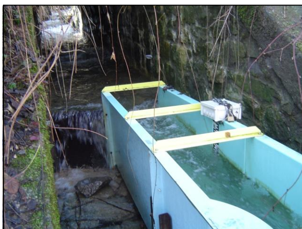
Photo 10 : Canal venturi du ruisseau du Pamphiot (Orcier)
