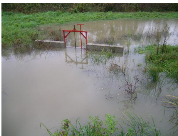
Figure n°II.10. Ouvrage du site de Bassol à Mézériat en crue.
