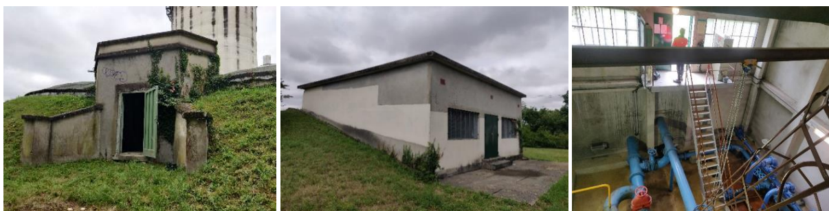
Figure 30 : Réservoir du Clos de Pinéa à Charvieu-Chavagneux (extérieur de la cuve dite « ancienne » à gauche, de la cuve dite « nouvelle » au centre et chambre à vanne de la cuve dite « nouvelle » à droite)
