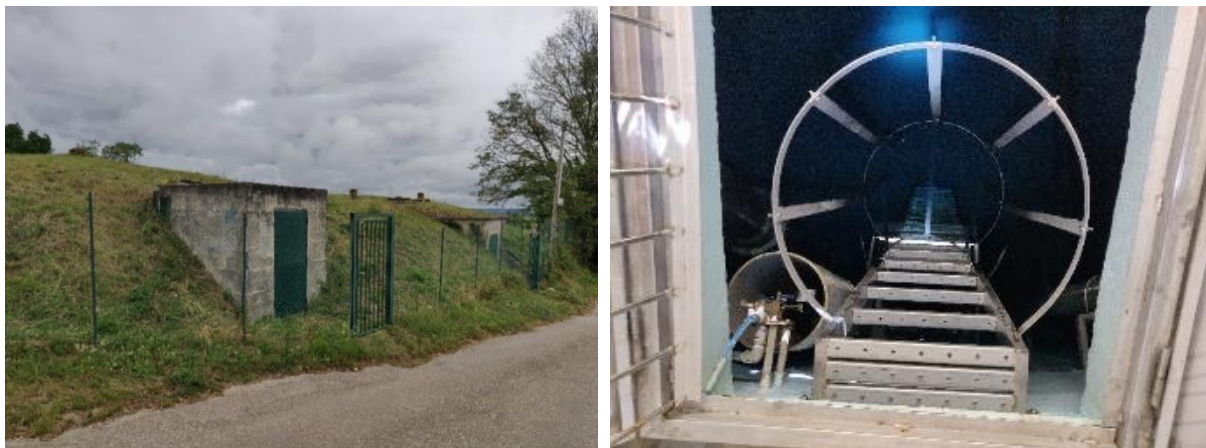
Figure 29 : Réservoir Les Ruines à Janneyrias (gauche) et cuve du réservoir d'Asnières à Villette-d'Anthon (droite)
