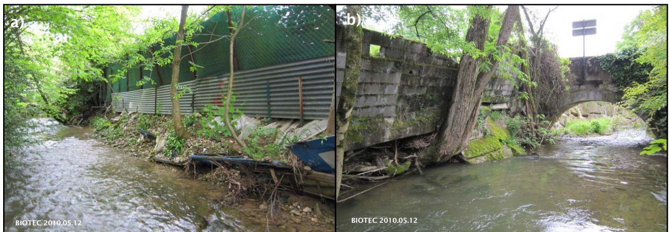
Figure 6. Vues d'un secteur dynamique et fortement anthropisé de l'Albanne, dans la traversée du hameau de Chacusard (T4) : a) protection rustique en tôles ondulées; b) muret en parpaings en train de s'écrouler, reposant sur des "piles" constituées de bidons.
