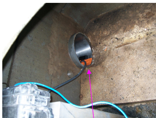
Déversoir d'orage en DN 300mm
