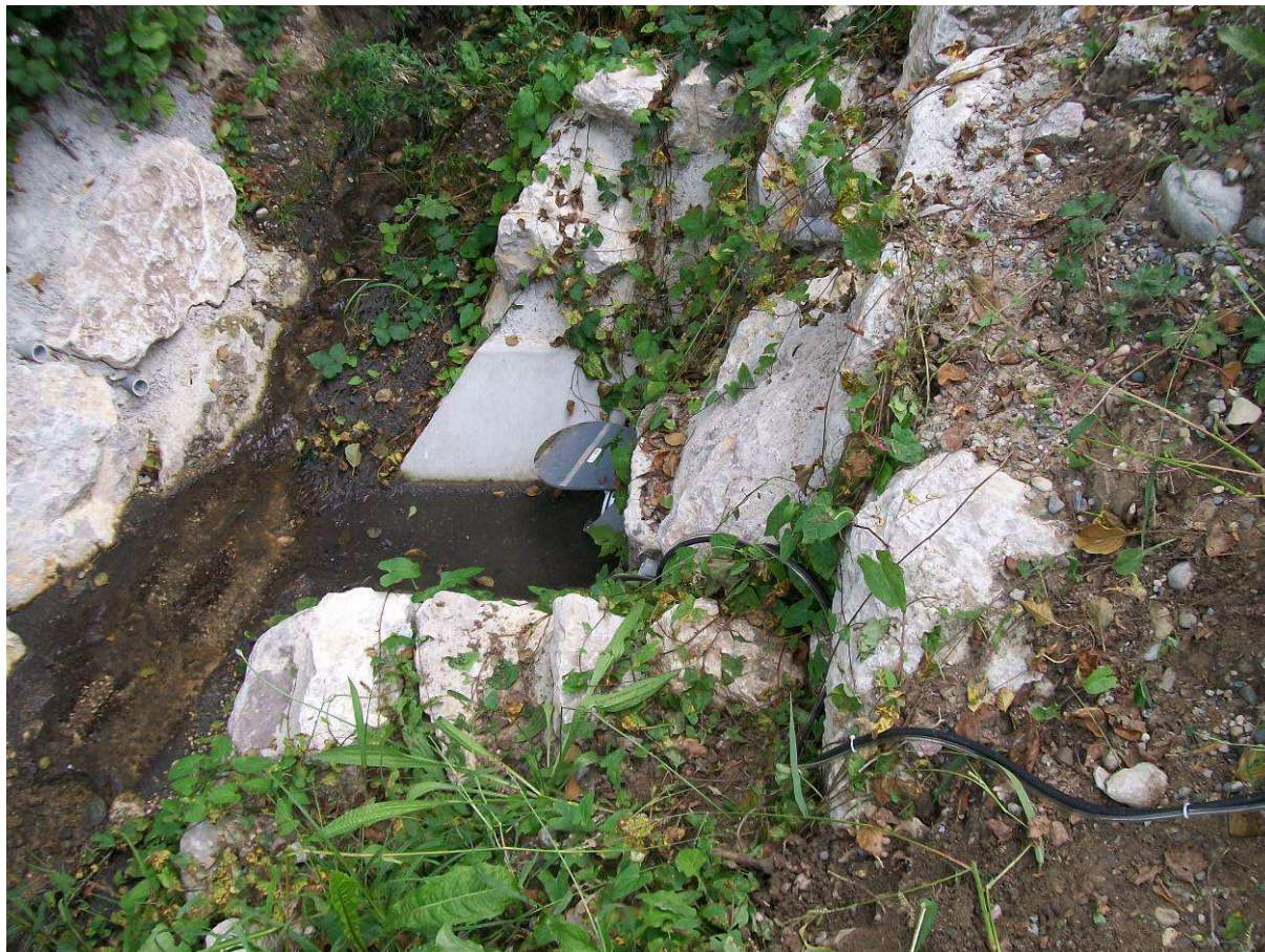
Déversoir d'orage à la lagune de Cervens
