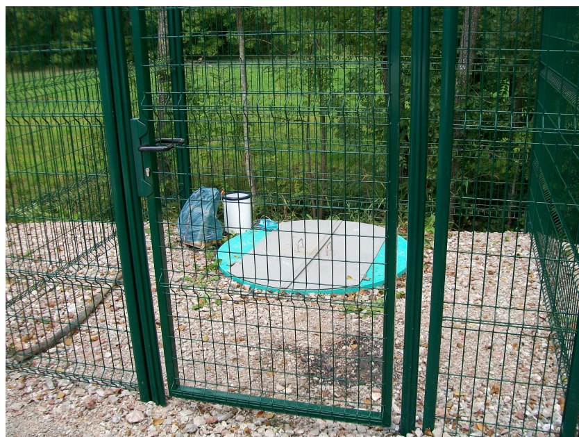
Pluviomètre installé au niveau du déversoir d'orage
