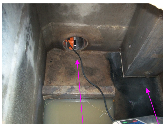
Déversoir d'orage en DN 300mm
