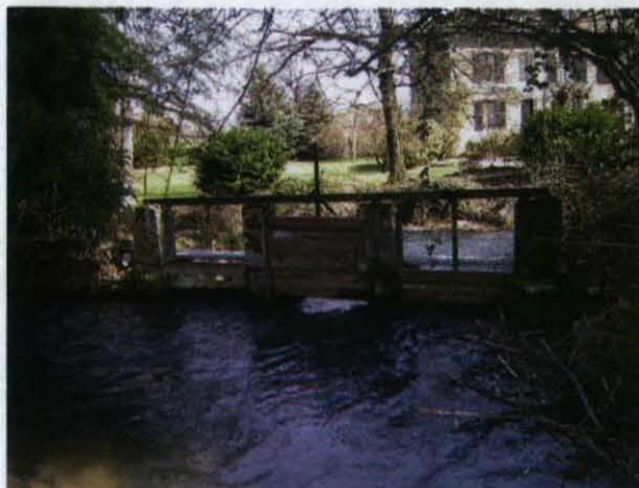
Vannes en travers du canal de Saint Jean de Chépy
