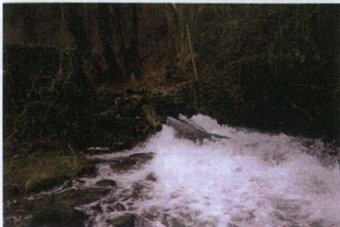
Digue effondrée d'un ancien étang (CSP, 1999)
