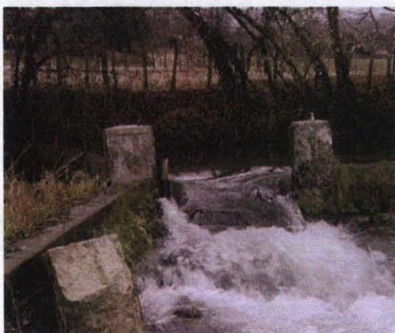
Prise d'eau M. Collomb Fils (CSP, 1999)
