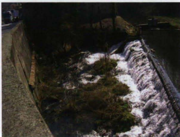
Ouvrage sur le tronçon T5 qui empêche totalement la libre circulation piscicole
