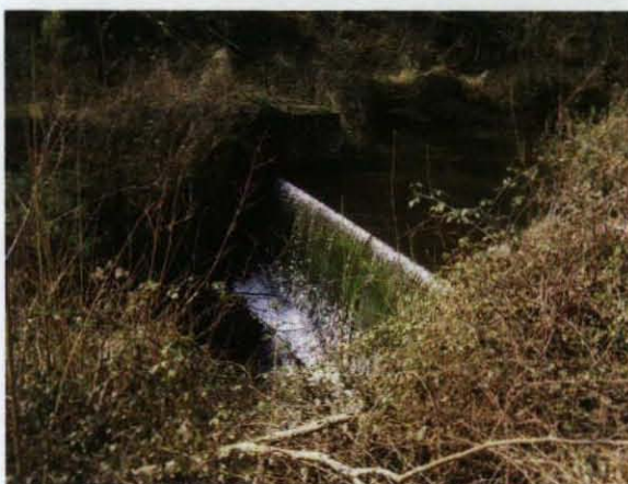
Ouvrage infranchissable à l'aval du tronçon T17
