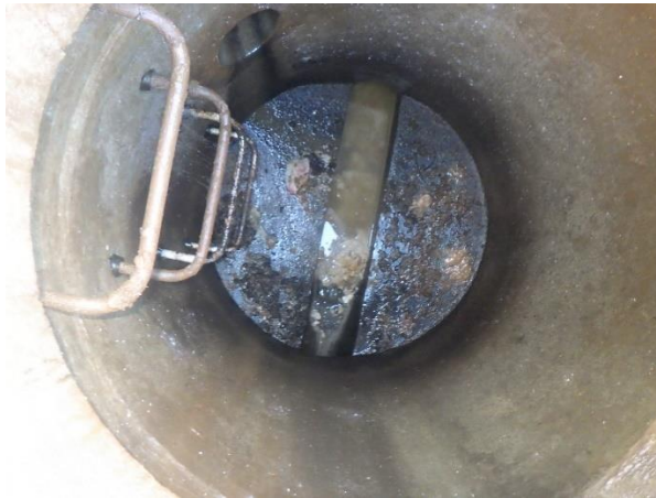
Dépôts– Regard 137 – Rue de L’odion
