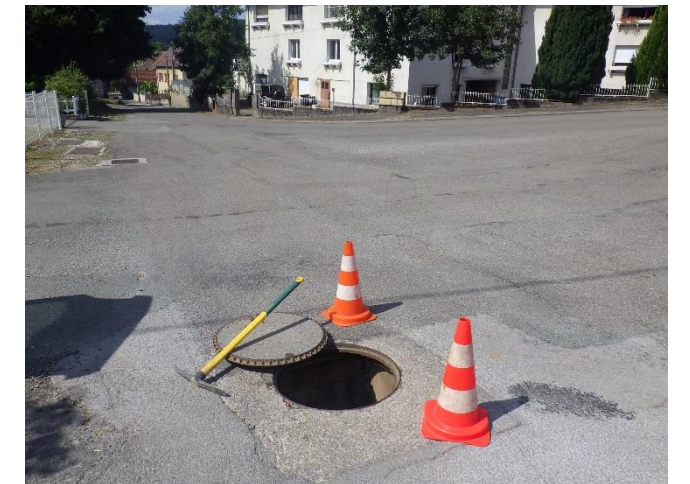
Chambre de vanne – Rue des Noyes
