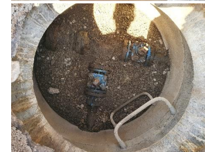
Chambres de vannes (Rue de Saint-Claude)
