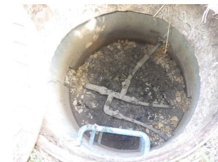
Chambres de vannes (Chemin de Boulan)
