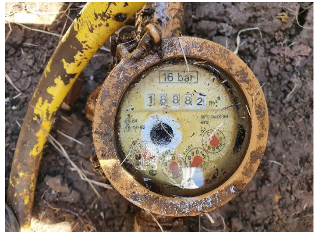
Compteur de sectorisation
