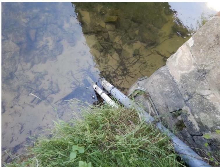
Photographie 6 : dépôt de sédiments fins en bordure au droit de la crépine du préleveur de Chenecey-Buillon, situation en mai 2022.
