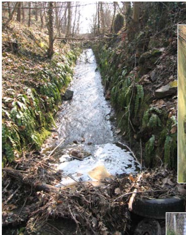
radier en pierres maçonnées infranchissable
