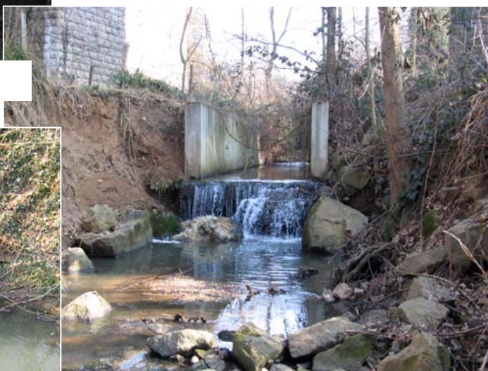
section bétonnée infranchissable
