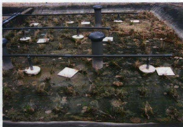
Figure 2 : ramps d'alimentation du deuxième étage de traitement. Burdignes le 24/04/2006
