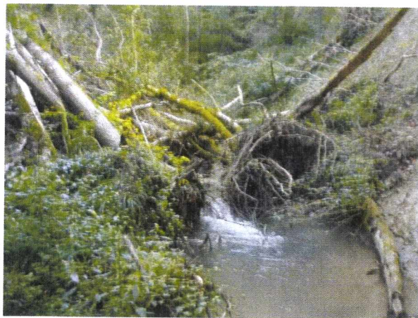
Photo 5 : Bouchon hydraulique avec accumulation d'embâcles
