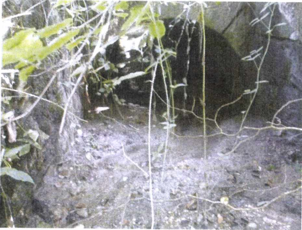
Photo 1 : Ouvrage de la VC n°10 envasé, la présence de bois morts provoquant des atterrissements
