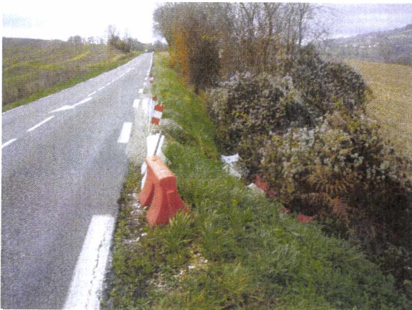
Photo 2 : affaissement du talus de la RD 910
