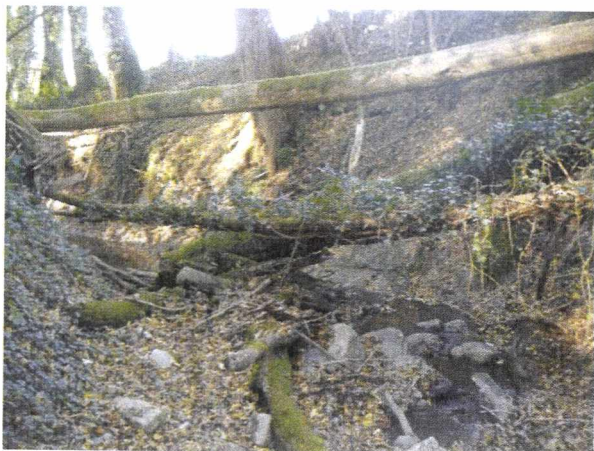
Photo 5 : Embâcles peu gênant pour l'écoulement hydraulique
