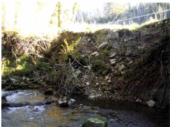
Photo 10 : Berge érodée au pied de la roue d'accès à la nouvelle station d'épuration de Thusy
