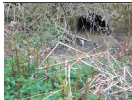
Rejet d'eaux usées et renouées du Japon
