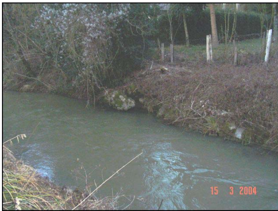
Photo 3 : propriété Buffier (à l'amont de la précédente). Certains enrochements se sont désolidarisés et gisent au fond de l'eau, provoquant hausse locale de la ligne d'eau
