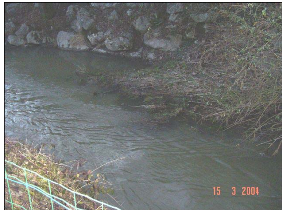
Photo 6 : un des nombreux écroulements de berge au niveau du premier virage à 180 degrés
