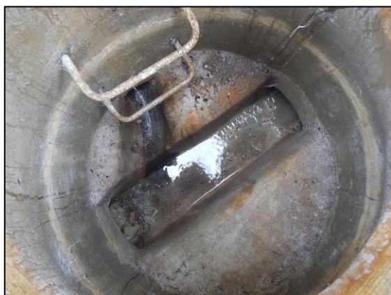
Regard de visite sur réseau unitaire
