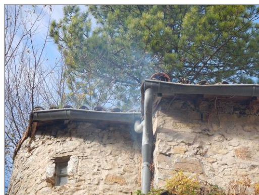
Anomalie n°4 : Gouttière
