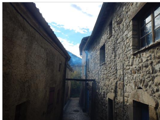
Anomalie n°5 : Gouttière
