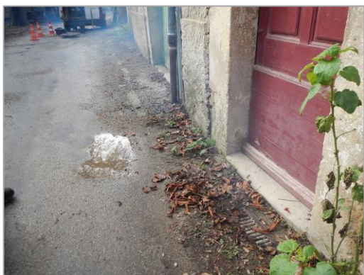
Anomalie n°1 : Chemin de grille
