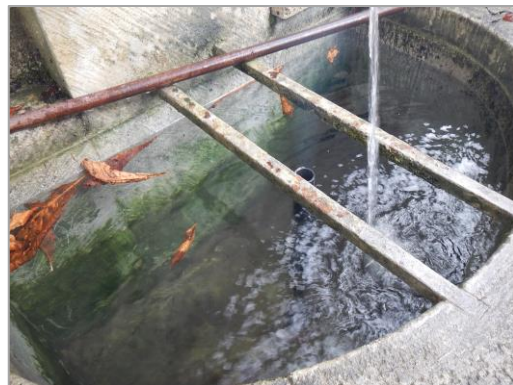
Anomalie n°9 : Trop-plein de la fontaine
