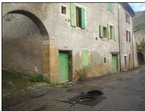
Accès au regard de visite
