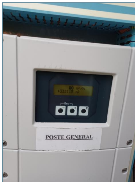
Débitmètre poste de refoulement
