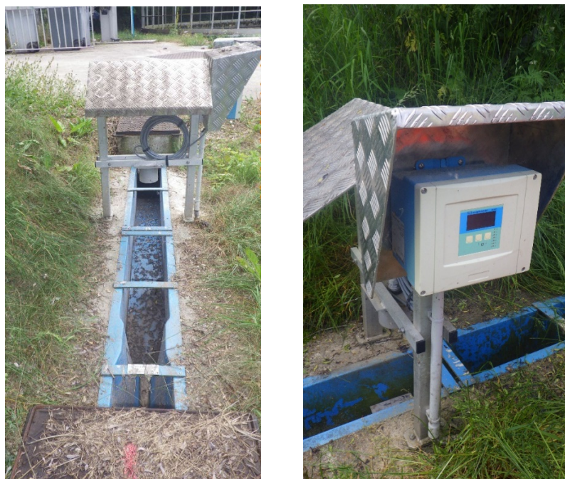
Figure 3 : Exemple de canal de comptage muni d'une sonde ultrason et d'un débitmètre
