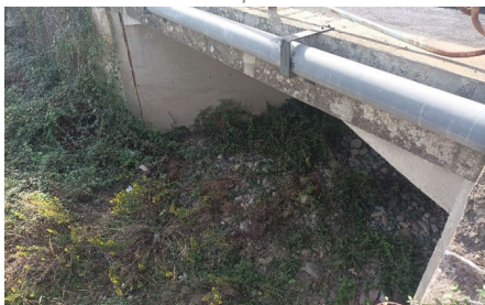
Visite d'un ouvrage de franchissement sur le ruisseau de Pietre Turchine – fréquence 2 ans
