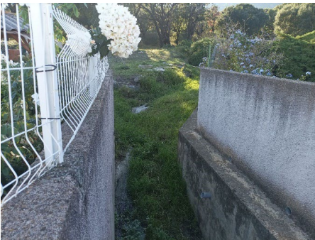
Ouvrage sur le Ficabruna à risque embâcles moyens demandant un entretien enjeu fort tous les 2 ans
