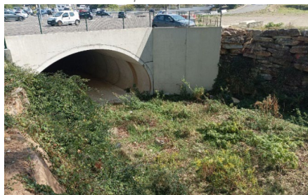
Visite d'un ouvrage de franchissement sur le ruisseau de Mormorana – fréquence 5 ans
