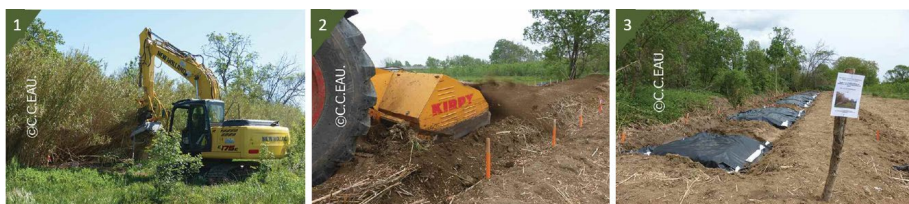
Illustration d'étapes du chantier expérimental réalisée par CCEau et le SMBFH en 2015 : 1. Débroussaillage avec une épaveuse – 2. Broyage du sol avec un broyeur à pierre – 3. Parcelles expérimentales après broyage
