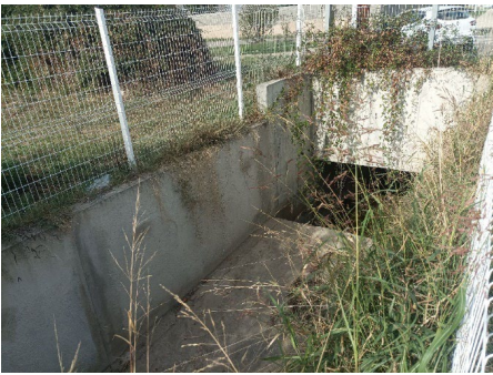
Ouvrage sur le ruisseau de Petrelle à risque embâcles fort et enjeux fort demandant entretien tous les 6 mois
