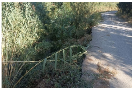
Visite d'une zone d'érosion sur Le Bevinco – fréquence 1 an
