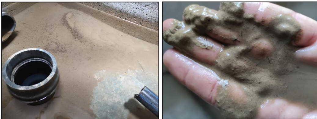
Fines présentes dans l'ouvrage de drain gauche (13/07/2022)
