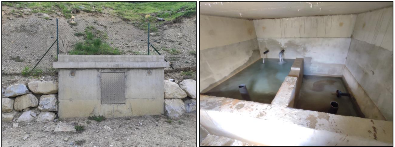
Ouvrage de réunion des eaux des captages de la Rochette (13/07/2022)
