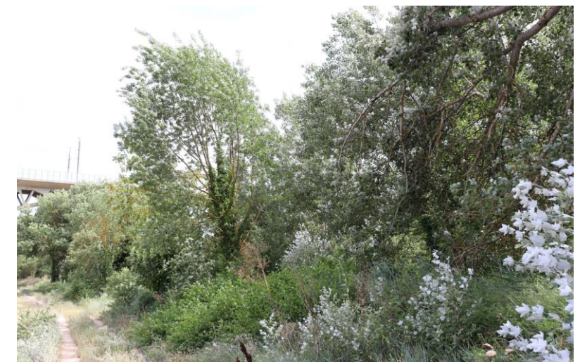
La digue, noyée sous la végétation, en bord de chemin agricole privé
