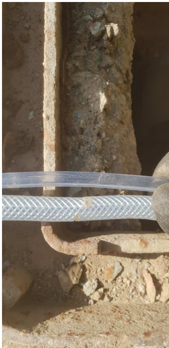
Tuyaux débitmètre abimés par le passage de véhicules
