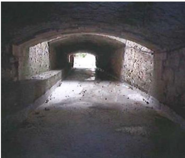
Illustration 10 photo du radier en 2017 (source : PV d'inspection par l'infrapôle PACA de SNCF du 11 octobre 2017)
