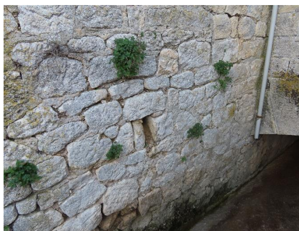
Disjointement de 8 cm maxi sur le mur de soutènement côté Marseille de la tête amont
