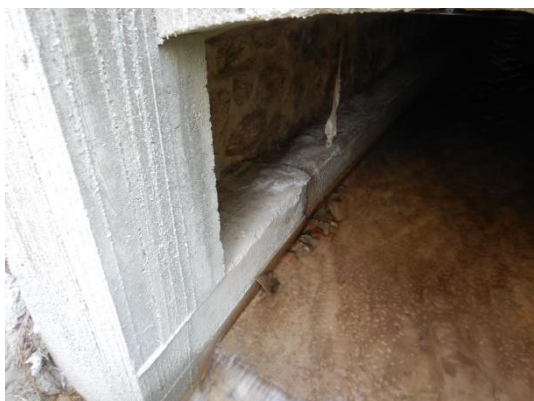
Absence de continuité entre la longrine et la berge en aval rive droite du fait de la pile
