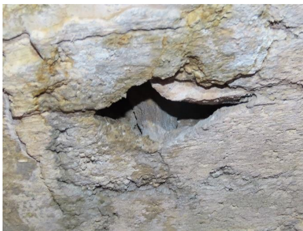
Cavité à proximité de la tête amont côté Marseille
