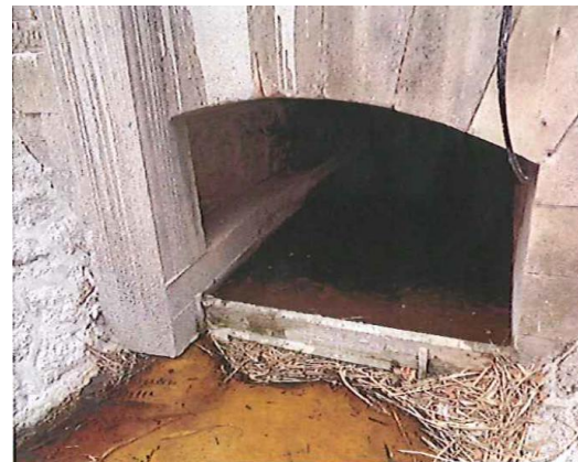
Illustration 17 coffrage noté en 2017 maintenant de l'eau stagnante en été et constituant une rupture pour la faune (source : PV d'inspection par l'infrapôle PACA de SNCF du 11 octobre 2017)
