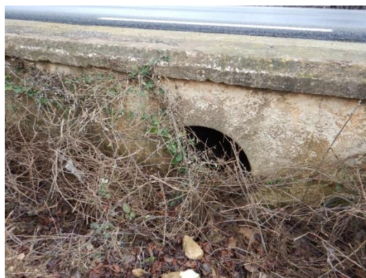
Ouvrage hydraulique sous la RD10 encombré par la végétation (à 700 mètres à l'est)
