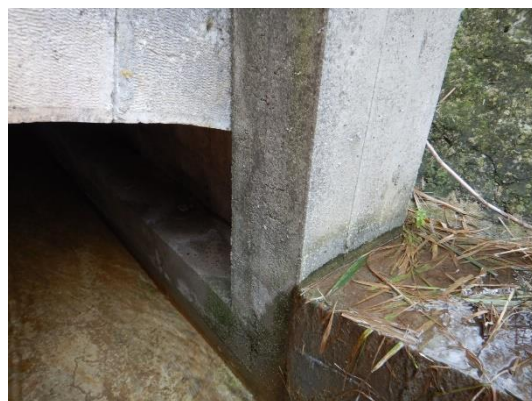
Absence de continuité entre la longrine et la berge en amont rive droite du fait de la pile
