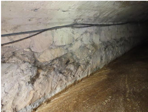
Dégradations au niveau du piedroit côté Marseille du tube Amont
