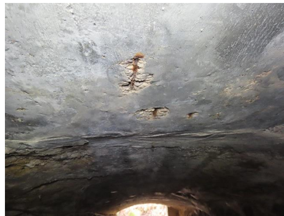
Eclat de béton et aciers apparents corrodés sur la voûte du tube Aval
