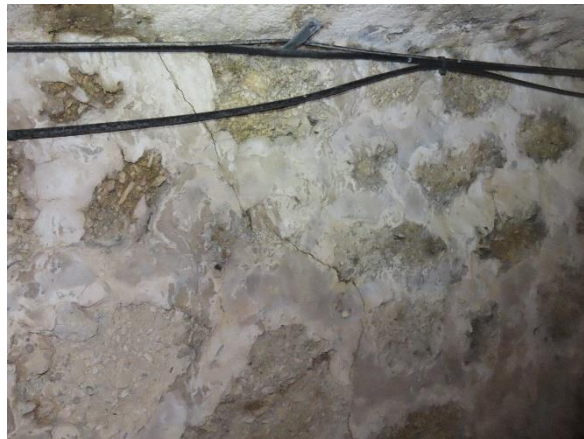
Fissure transversale d'ouverture 0,4 mm à quelques mètres de la tête aval
