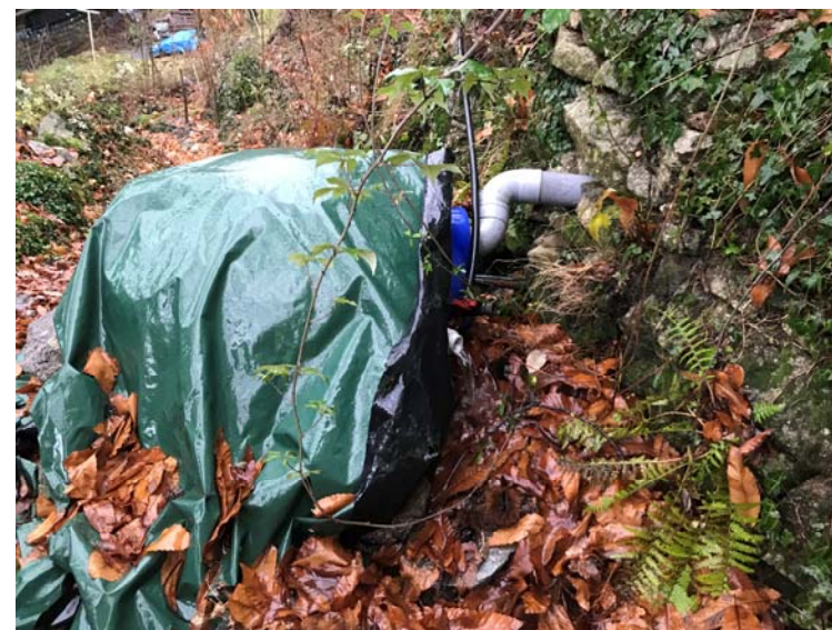
Chambre de captage appartenant à l'ASL
