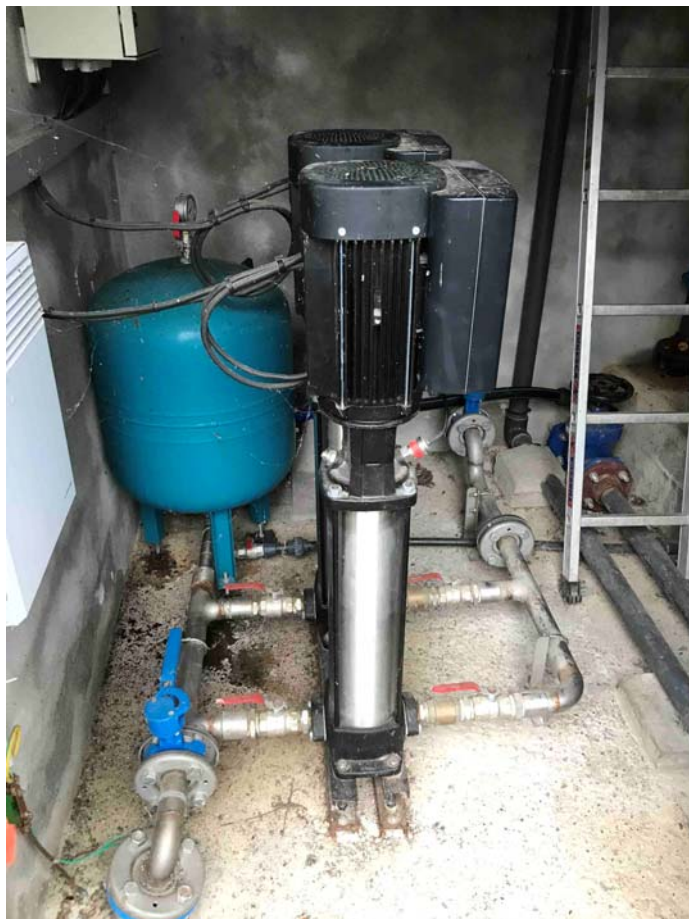
Vu du groupe de surpression dans la chambre de vanne du réservoir
