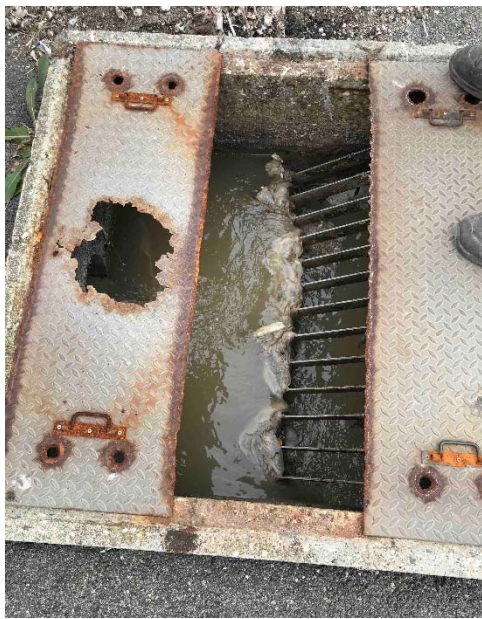
Dégrilleur dessableur en tête de PR
