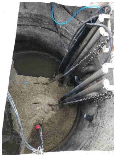
Cuve du PR avec pompes et sondes
