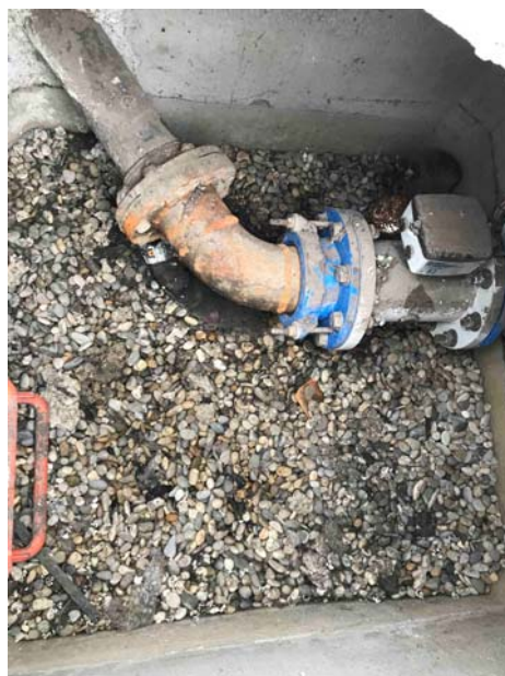
Départ du refoulement avec débitmètre
