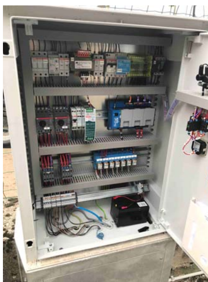
Armoire de commandes électriques avec Sofrel 54W
