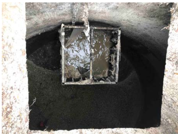
Panier dégrilleur dans le PR
