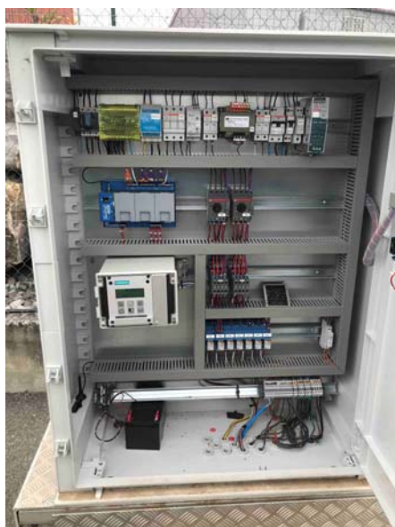
Armoire de commandes électriques avec Sofrel 54W
