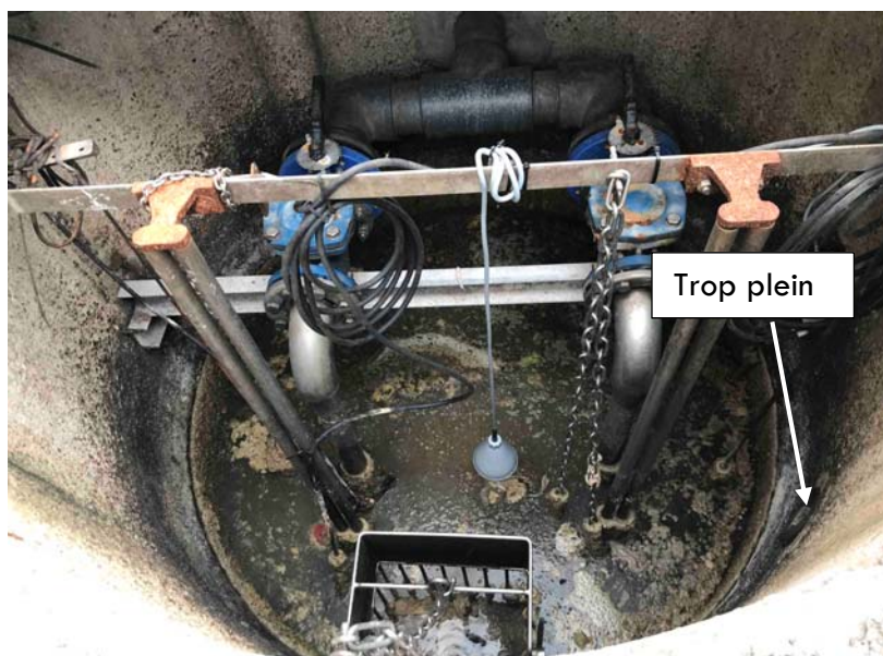
Cuve du PR avec pompes et sondes ainsi que panier dégrilleur
