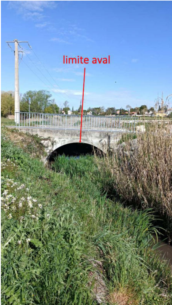
Date: 18/04/2023 Crédits: FDAAPPM13 Localisation: Budeou st Cannat "stade" limite aval
