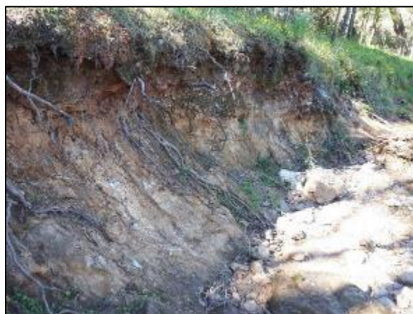
Berge en rive gauche érodée
