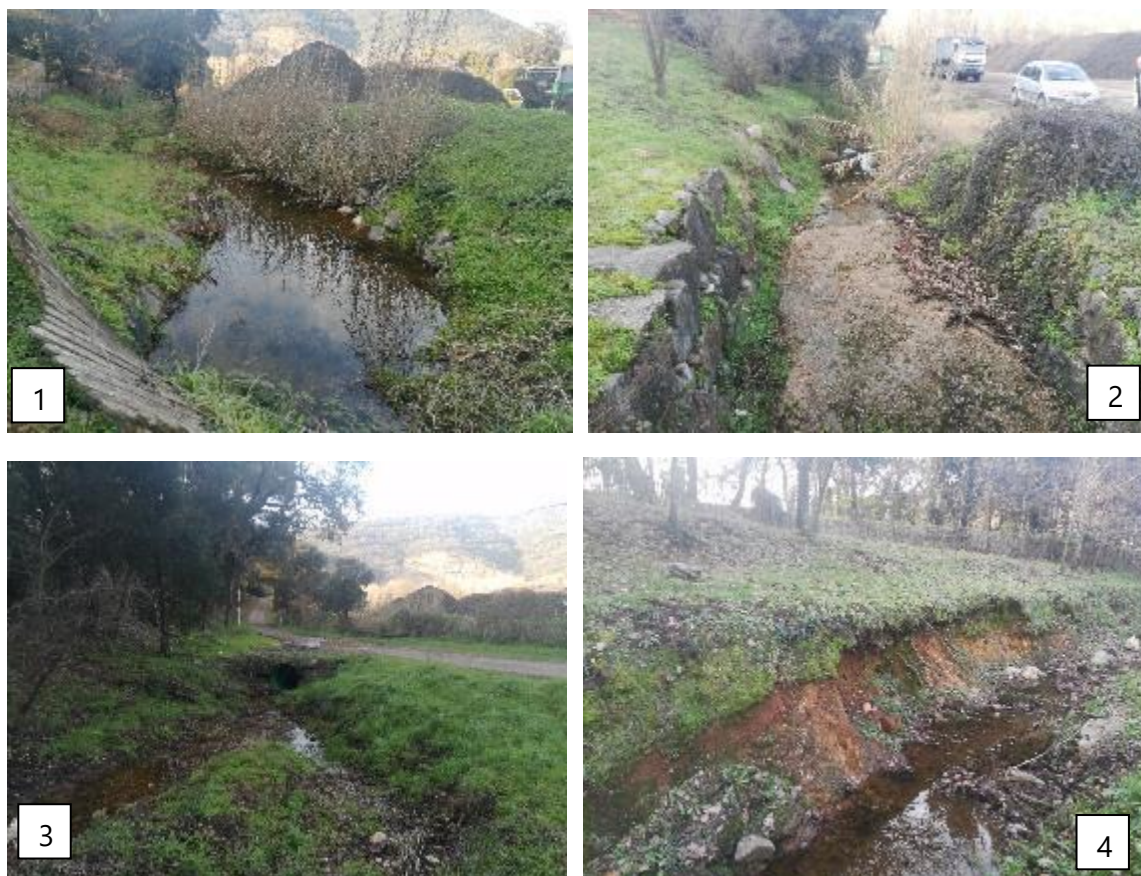
Figure 2: Exemples de désordres observés (1-Enrochements présents et canne de Provence, 2-Enrochements et radier béton, 3-ouvrage hydraulique transversal, 4-zone d'érosion de berge)
