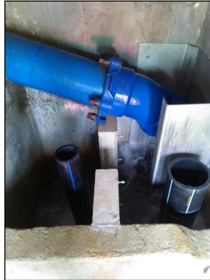
Photo 8 : Intérieur du captage de Moullière
