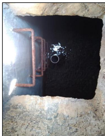
Photo 10 : Intérieur du captage de Preyt
