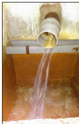
Photo 2 : Intérieur du captage de la Sarpatière
