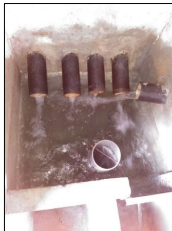
Photo 4 : Intérieur du captage de Lauzeron
