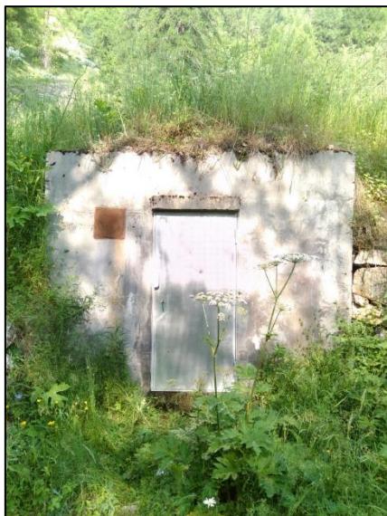
Photo 5 : Captage du Sapet
