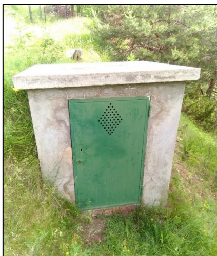
Photo 1 : Captage de la Sarpatière
