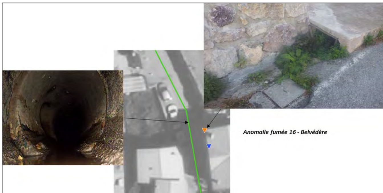
Illustration 15 : Exemple défaut d'étanchéité réseau mis en évidence par les tests à la fumée – Anomalie 16 - Belvédère
