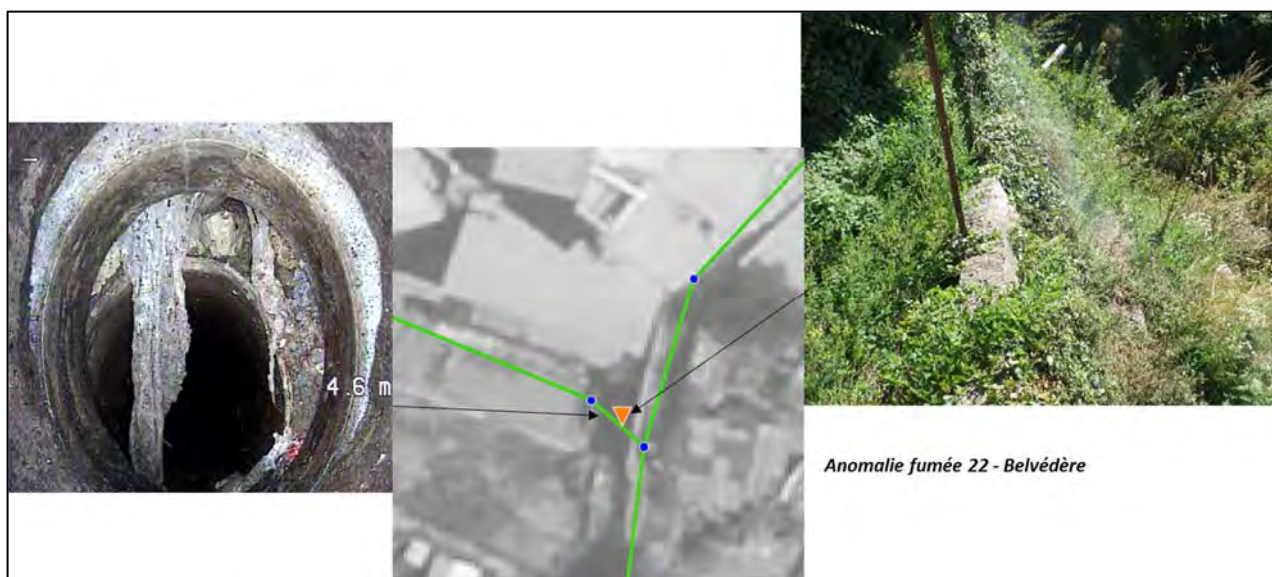
Illustration 16 : Exemple défaut d'étanchéité réseau mis en évidence par les tests à la fumée – Anomalie 22 - Belvédère
