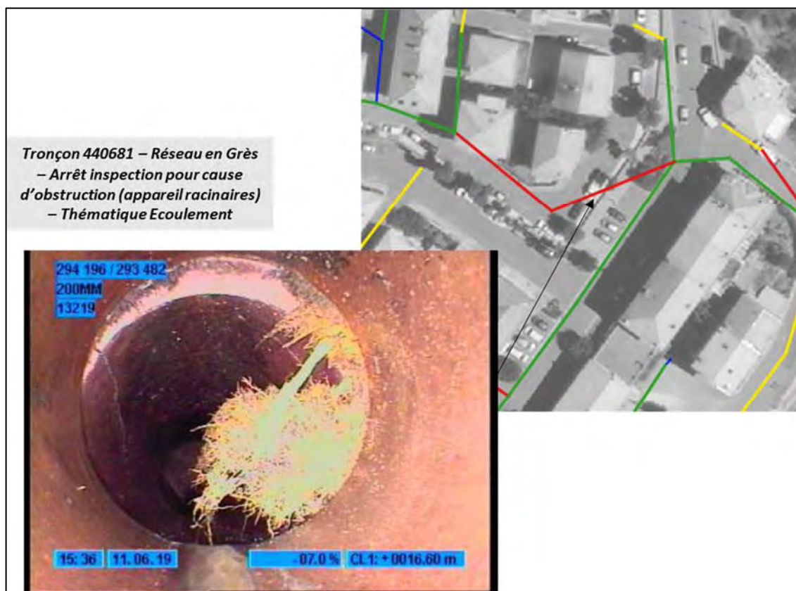
Illustration 29 : exemple 2 anomalie Écoulement grave identifiée à l'ITV commune de Roquebillière - racines entravant l'écoulement + déboitement
