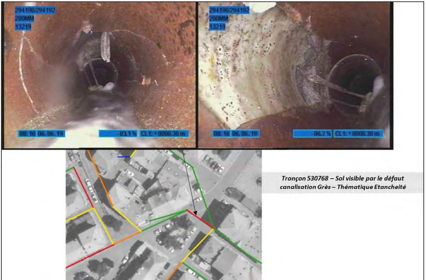
Illustration 38 : exemple thématique « Étanchéité » – sol visible par défaut structurel – réseau en grès.
