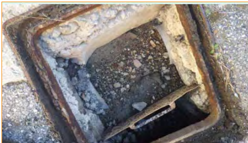
Illustration 7 : photographie d'un regard de collecte dont l'état structurel général a été jugé de "mauvais"
