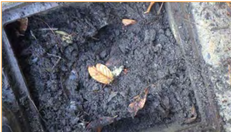
Illustration 6 : photographie d'un regard de collecte dont l'état structurel général a été jugé de "médiocre"
