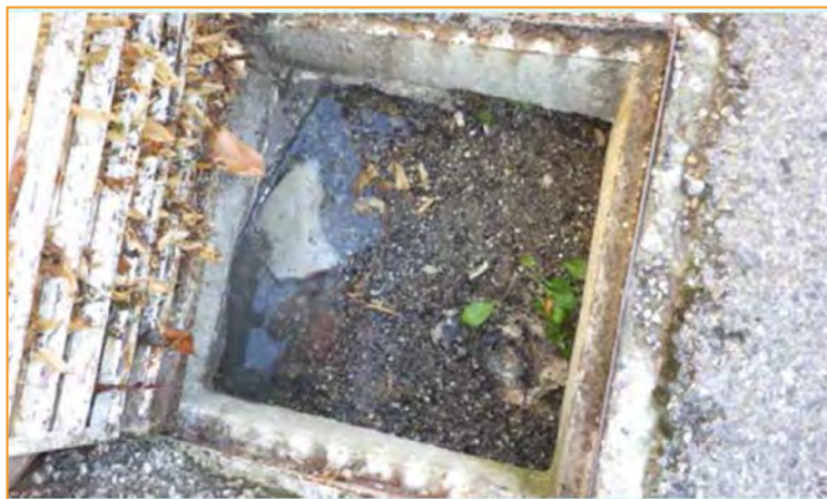
Illustration 7 : photographie d'un regard de collecte dont l'état structurel général a été jugé de "mauvais"
