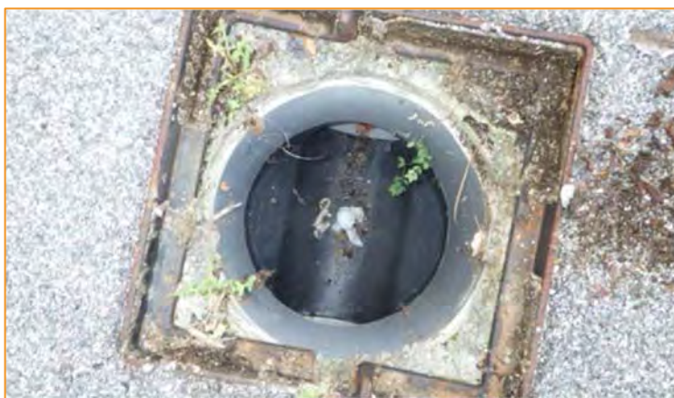
Illustration 4 : photographie d'un regard de collecte dont l'état structurel général a été jugé de "bon"
