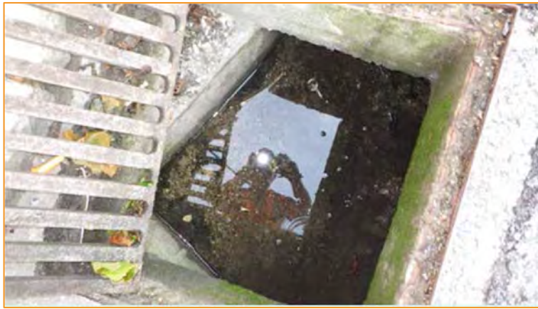
Illustration 5 : photographie d'un regard de collecte dont l'état structurel général a été jugé de "moyen"
