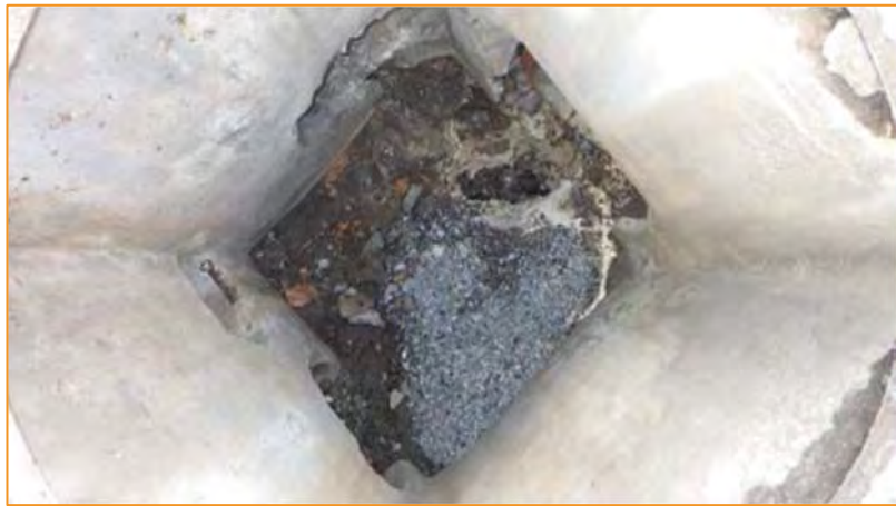
Illustration 6 : photographie d'un regard de collecte dont l'état structurel général a été jugé de "médiocre"
