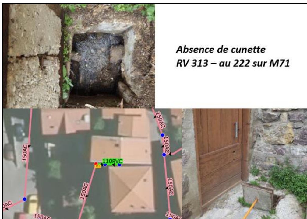
Illustration 28 : Exemple d'absence de cunette – Système du Zibac
