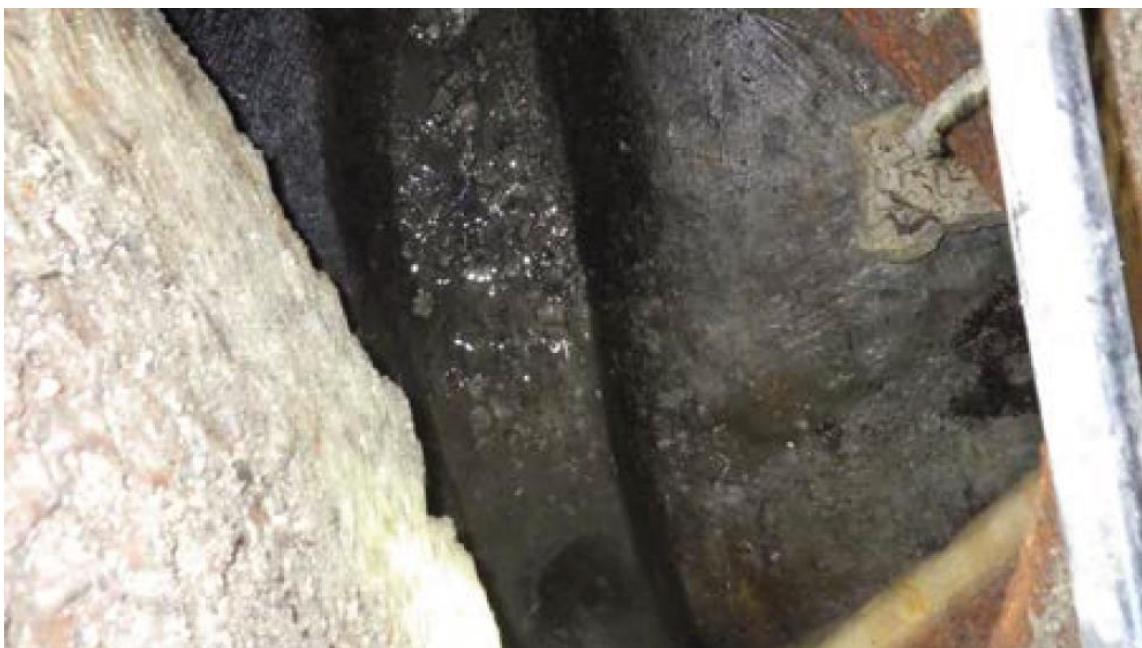
Illustration 30 : Défaut très grave de type abrasion ou corrosion - Système du Zibac
