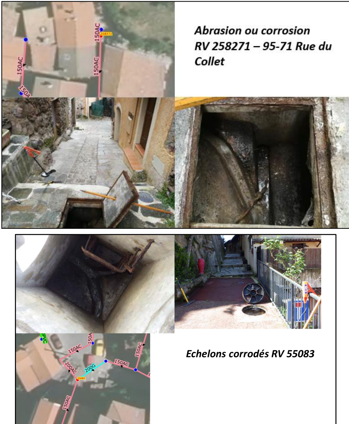
Illustration 11 : Exemples d'abrasion ou corrosion – Système du Boucart
