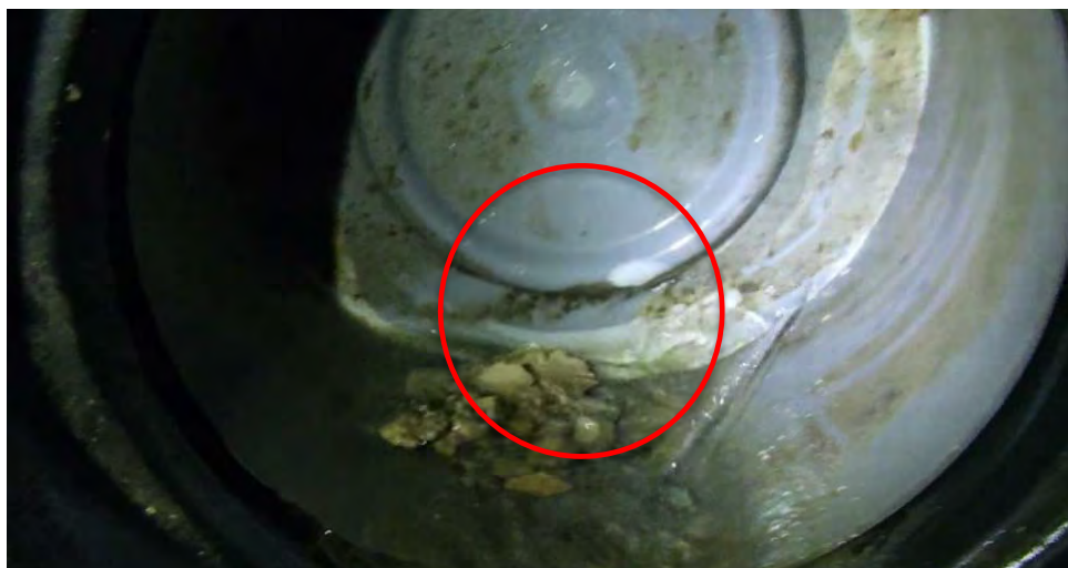
Figure 23 : Regard n°58434 – Rue Nationale – Infiltration par branchement
