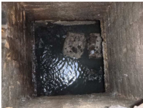
Cheminée regards R1- manque échelons–
