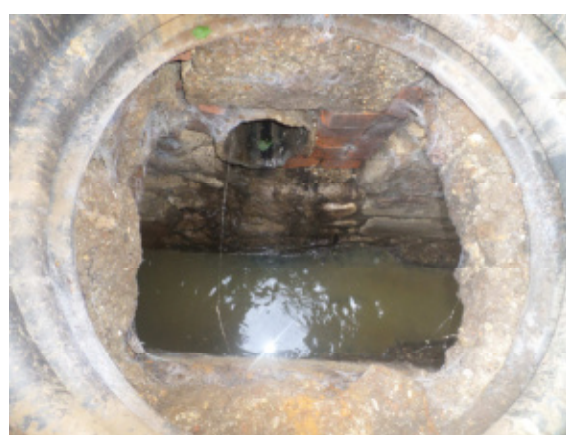
Déversoir d'orage du collecteur K vers les Sorguettes
