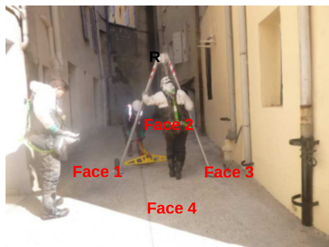
Vue regard d'accès au Sorguette– regard n°1
