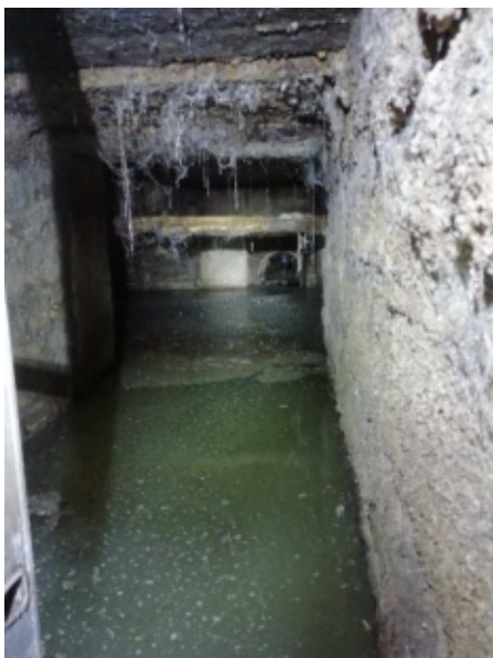
Chambre de transit Sorgette – vers Siphon – Effluent très chargé – Présence gaz H 2 S
