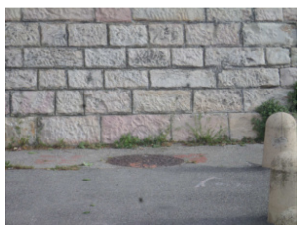
Regard de visite au niveau du raccordement des Sorguettes au collecteur Peyrault
