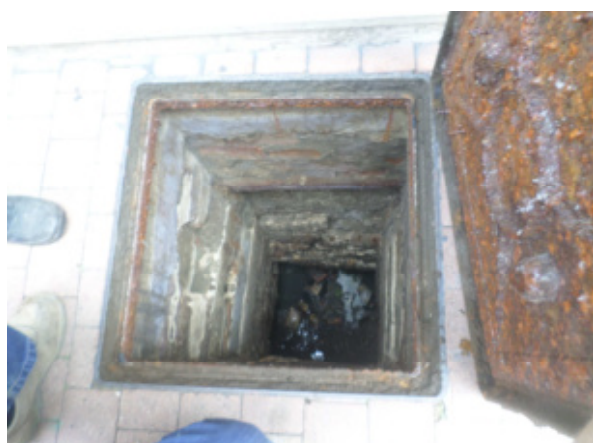
Regard d'accès aux Sorguettes R1
