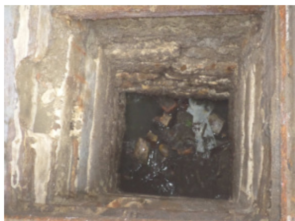
Regard d'accès aux Sorguettes R1
