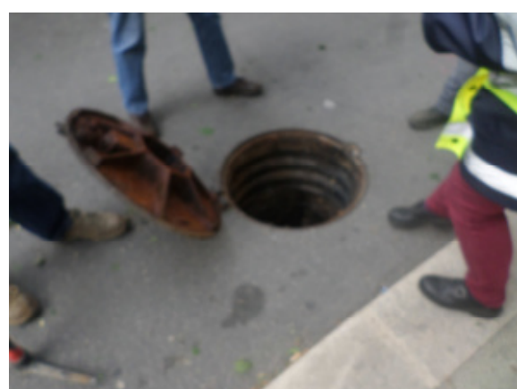
Déversoir d'orage du collecteur K vers les Sorguettes
