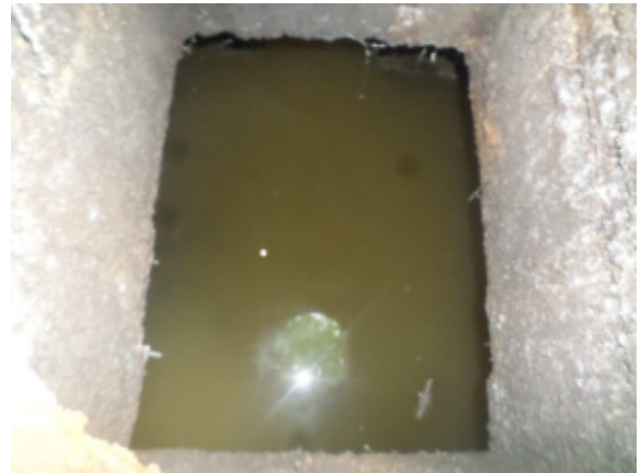
Regard d'accès aux Sorguettes – Place Pignotte
