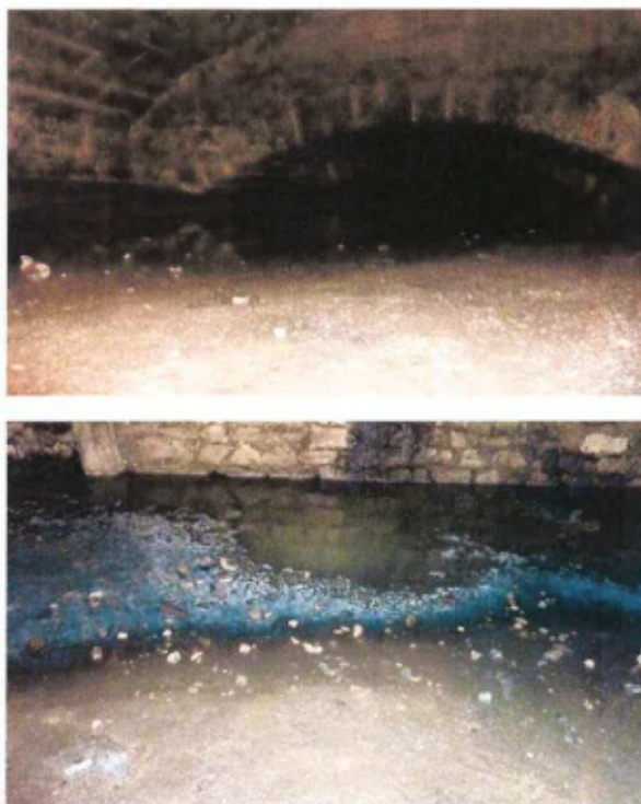
Envasement de ce tronçon des Sorguettes a plus de 75%.
