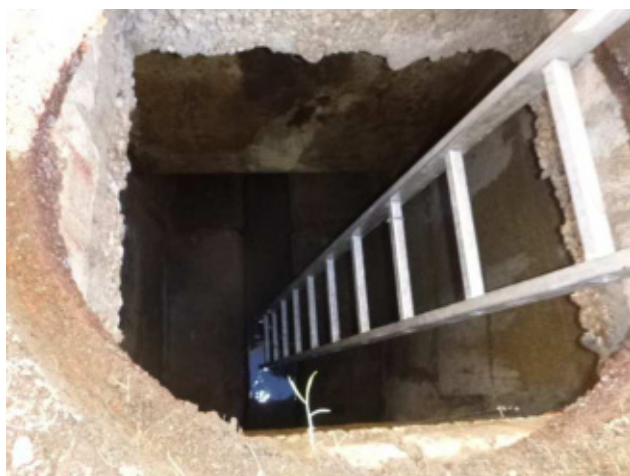
Cheminé d'accès – absence d'échelons et équipements
