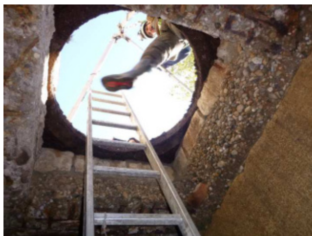
Cheminé d'accès – absence d'échelons et équipements
