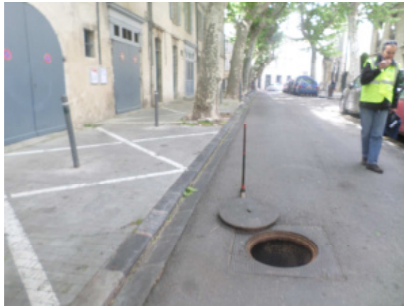
Regard d'accès aux Sorguettes – Place Pignotte
