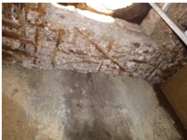
Tête de cheminée et dalle sous tampon avec ferrailage apparent
