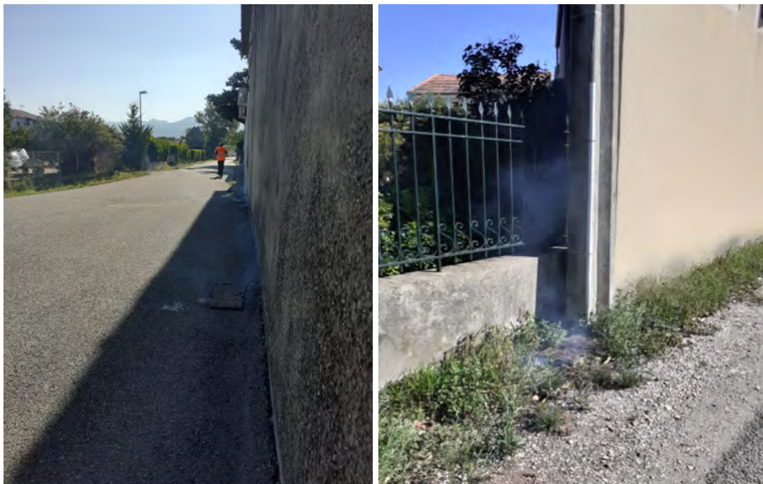
FIGURE 3 : Boites de branchement non étanche (Source : Egis)
