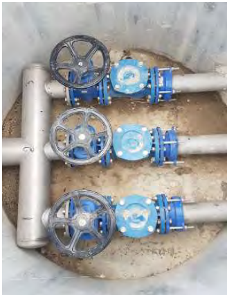
Chambre de vannes
