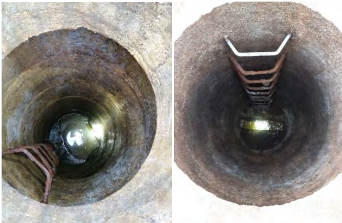
FIGURE 17 : Traces de mise en charge rue du 19 mars 1962 (Source : EGIS)
