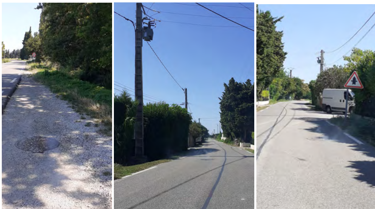
FIGURE 2 : Couvercles de regards non étanches (Source : Egis)
