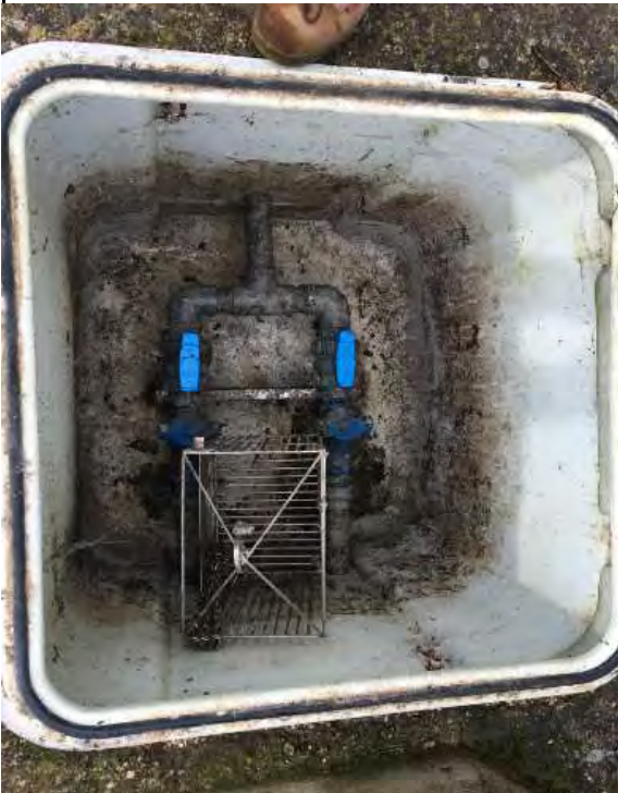
Chambre de vannes
