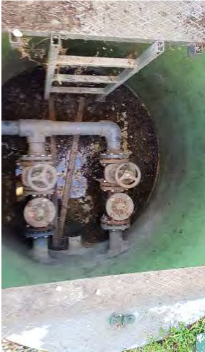
Chambre de vannes
