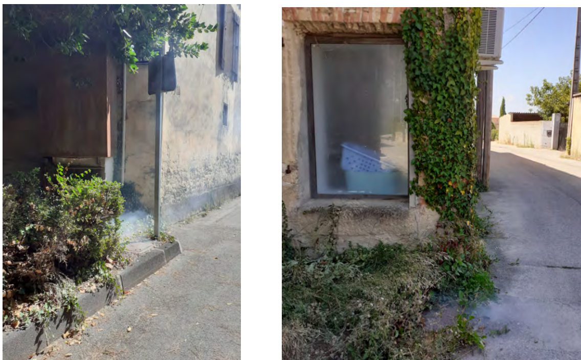
FIGURE 2 : Boitiers non étanche (Source : Egis)
