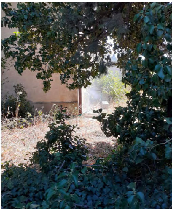
FIGURE 4 : Boitier non étanche (Source : Egis)
