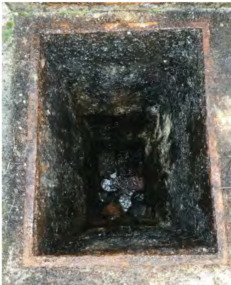
Figure 20 : Traces d'effluents industriels sur le regard avant PR Zac Florette (Source : Egis)
