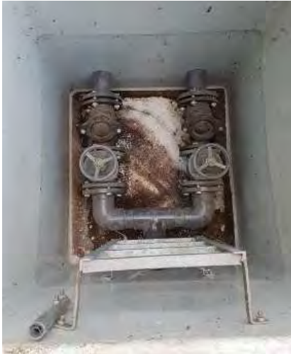
Chambre de vannes
