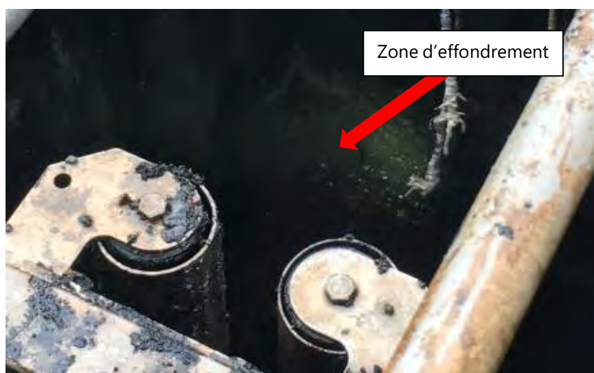
Figure 21 : Zone d'effondrement du PR Florette (Source : EGIS)
