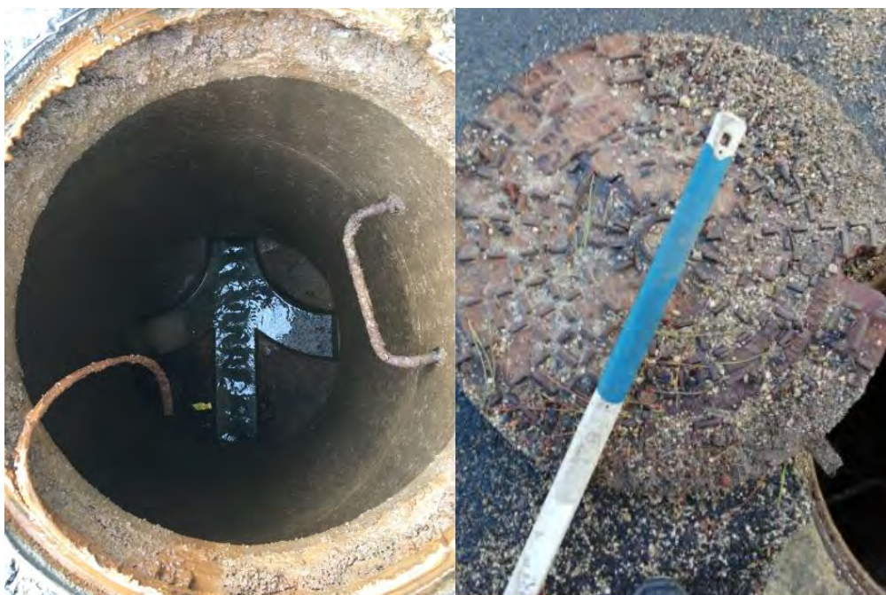
Figure 17 : Joint défectueux à gauche Avenue Jean Jaures et tampon cassé à droite au niveau du regard d'arrivée du PR de Bollene (Source : EGIS)
