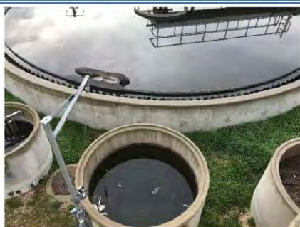
Dégazage et recirculation
