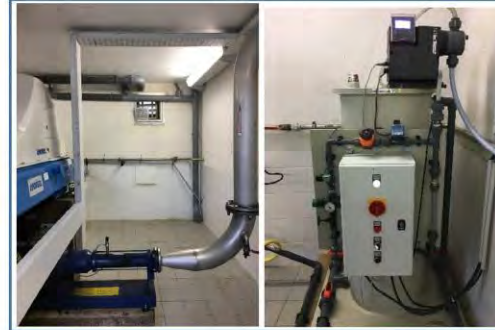
Alimentation de la centrifugeuse et injection polymère
