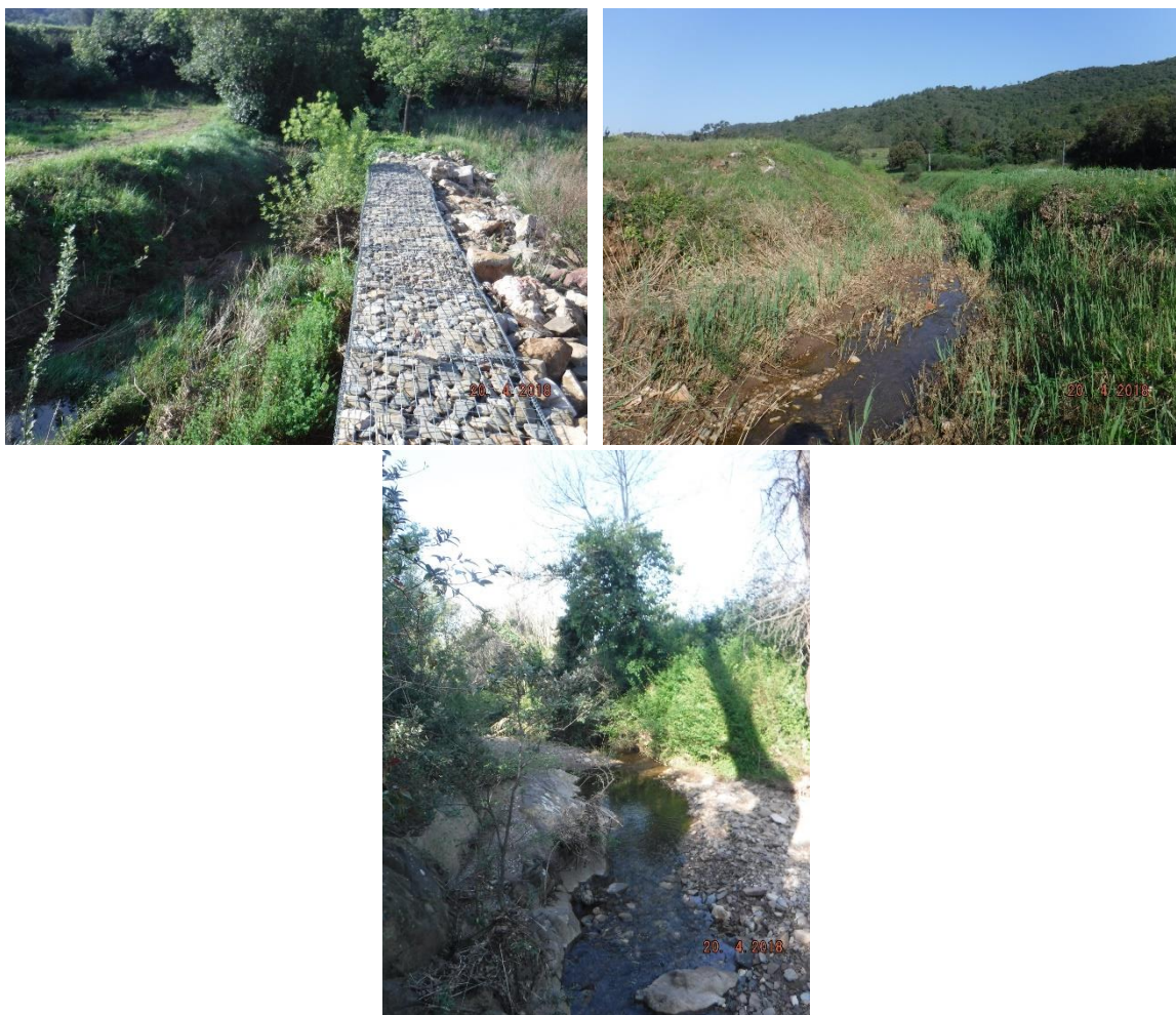
En haut à gauche : une protection de berge en gabion qui a dû être renforcée (vue vers l'aval). En haut à droite : une section surdimensionnée (vue vers l'amont) au niveau du Pk 3 (amont de 2° Borrels). En bas : le lit du ruisseau des Borrels au niveau du Pk 1.2 (aval de 2 Borrels).
