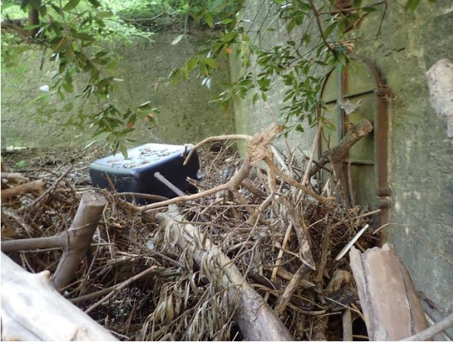
Figure 13 : pertuis complètement obstrué (barrage des 3 martelières)
