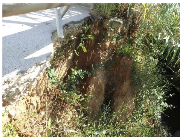
Figure 49 : effondrement de la route sous l'effet de l'érosion (Augias)
