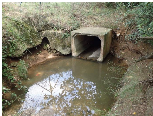
Figure 12 : érosion au niveau d'un ouvrage (Lazaret)
