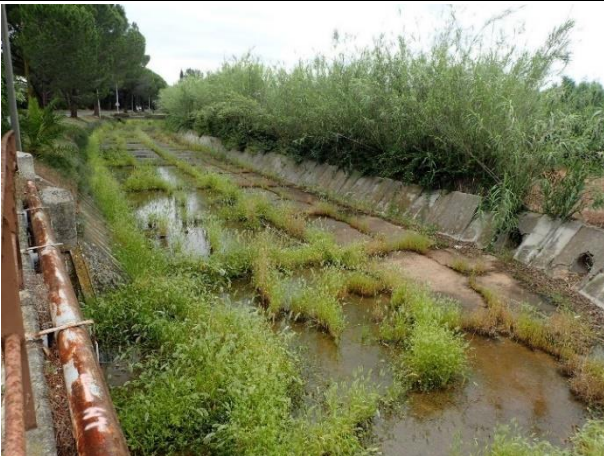
Figure 11 : plaques béton soulevées par les cannes de Provence le long du canal (Decugis)
