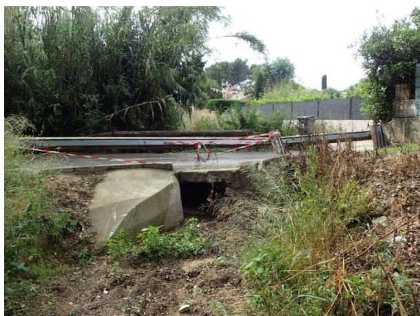
Figure 13 : risque d'embâcle sous un ouvrage récemment curé, pk 97.6 (Roumagnan)
