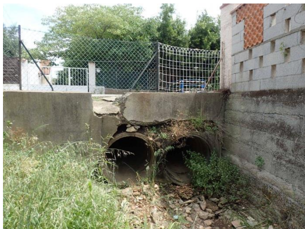
Figure 9 : passage couvert dégradé (Bouchou)
