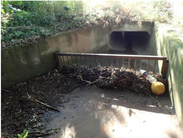
Figure 15 : grille en partie obstruée par des corps flottants en amont d'un ouvrage (Loup)
