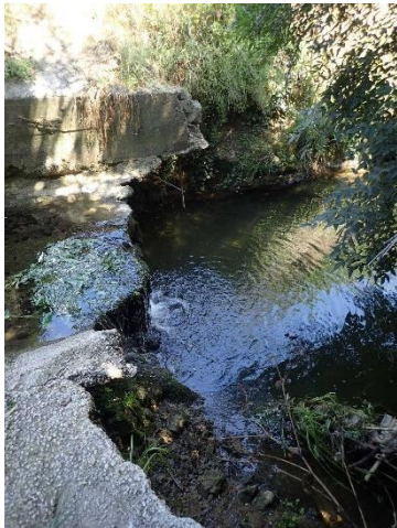
Figure 9 : radier béton dégradé (Real Baye un peu en amont de la confluence avec le Roubaud)
