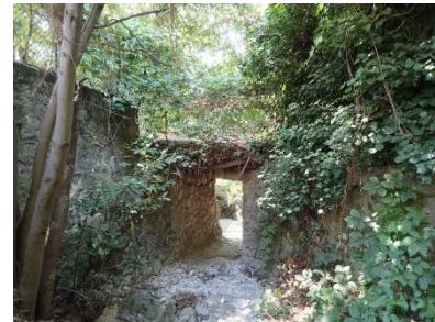
Figure 16 : ouvrages abandonnés et en mauvais état sur le Las et sur le Ripelle
