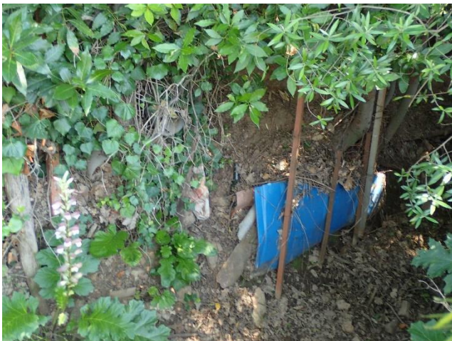
Figure 46 : ouvrage rustique et peu efficace pour consolider la berge (Saint-Jean Bis)
