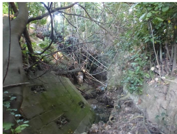
Figure 51 : effondrement d'un mur dans l'Oide
