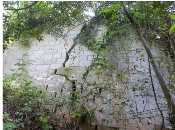
Figure 12 : mur en berge dangereux (Garonne)
