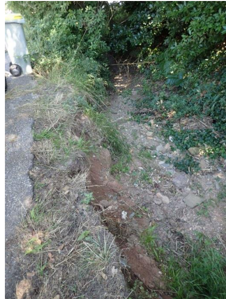
Figure 50 : routes menacées par l'érosion (Lazaret, à gauche et Oide à droite)
