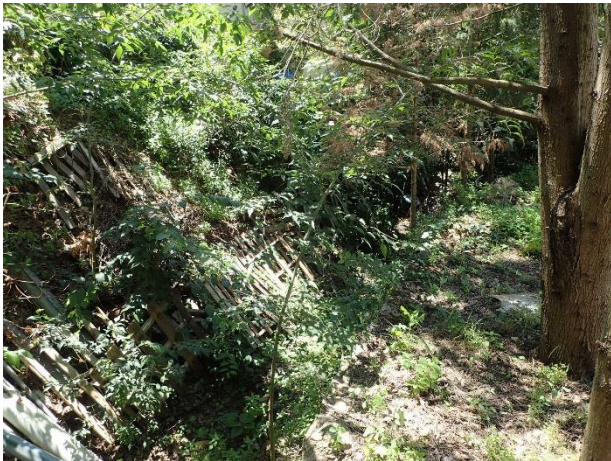
Figure 44 : barrières jetées dans le lit du cours d'eau (Moulins)
