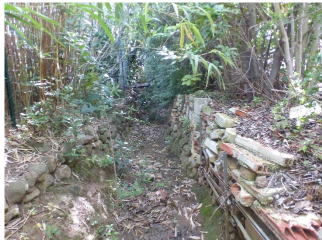
Figure 47 : ouvrage rustique et peu efficace pour consolider la berge (Grand Vallat)
