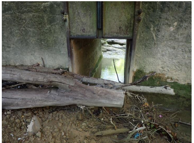
Figure 12 : pertuis partiellement obstrué (barrage des 3 martelières)
