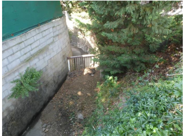
Figure 16 : grille encombrée par des sédiments et corps flottants sur l'Oïde en amont d'un passage couvert
