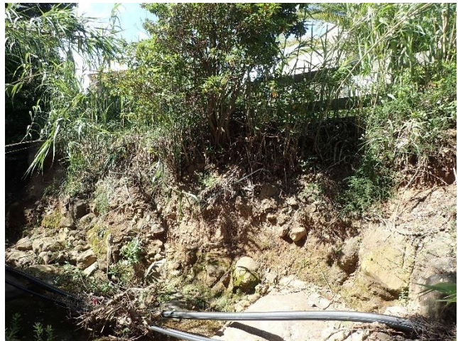
Figure 45 : érosion menaçant la route (Grand Vallat)
