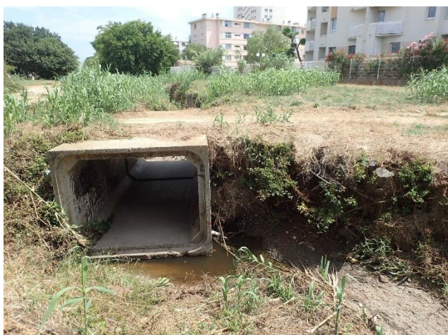
Figure 11 : érosion au niveau d'un ouvrage (Lazaret)
