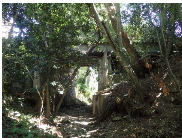
Figure 14 : arbres instables juste en amont du pont de la départementale (Oïde)
