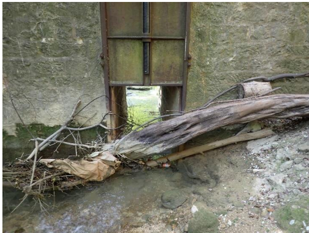
Figure 11 : pertuis partiellement obstrué (barrage des 3 martelières)
