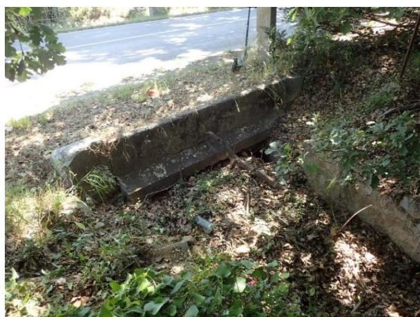
Figure 18 : ouvrage très encombré par des litières végétales en amont de la RD46, risque de débordement (Fenouillet)
