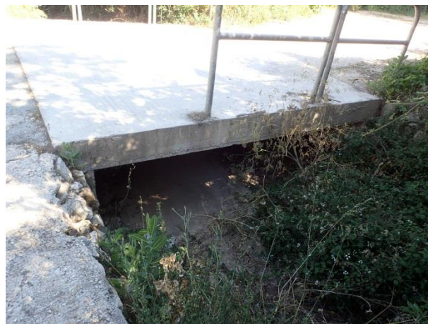
Figure 10 : ouvrage sous-dimensionné (Oïde)
