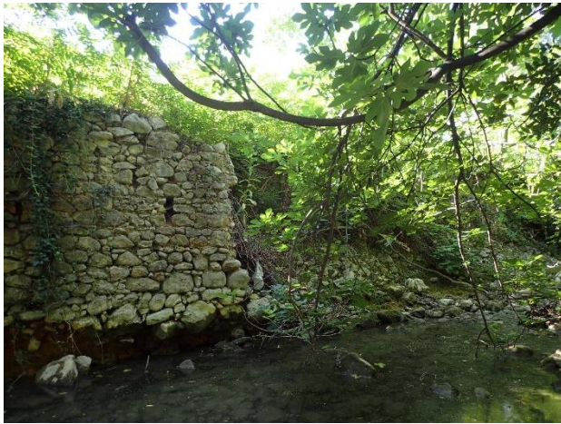
Figure 38 : vieux perré dégradé et érosion le long du Las
