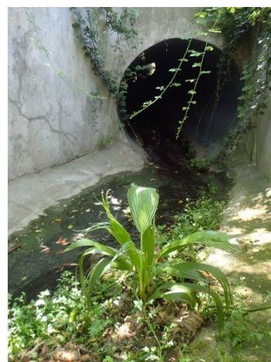
Figure 59 : palmier en amont d'un ouvrage (Real Baye)
