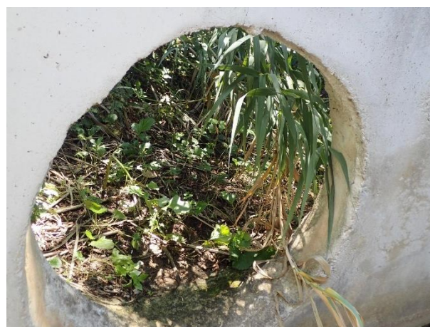
Figure 19 : ouvrage non entretenu et encombré (Real Baye)
