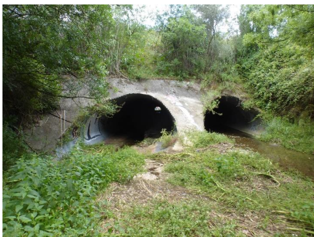
Figure 34 : banc alluvial à l'amont d'un ouvrage, à débroussailler pour éviter le développement des arbres
