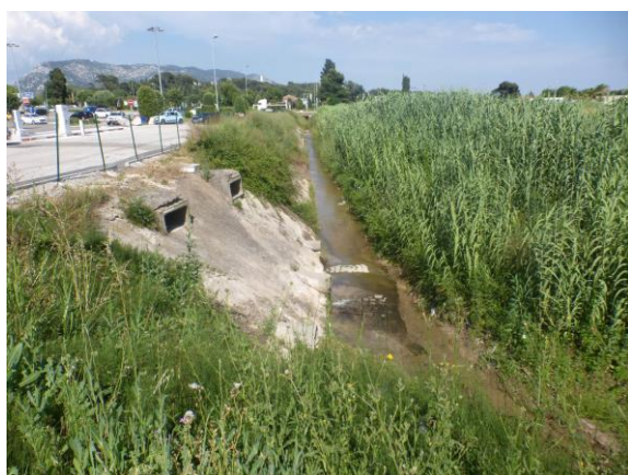
Figure 57 : lit envahi par les cannes de Provence suite aux travaux d'aménagements des abords (Faveyrolles)
