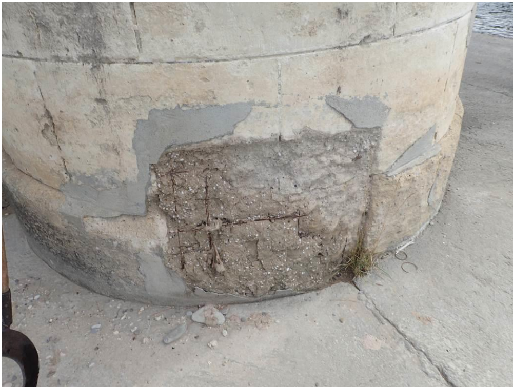
Figure 16 : Erosion d'un pied de pile du pont
