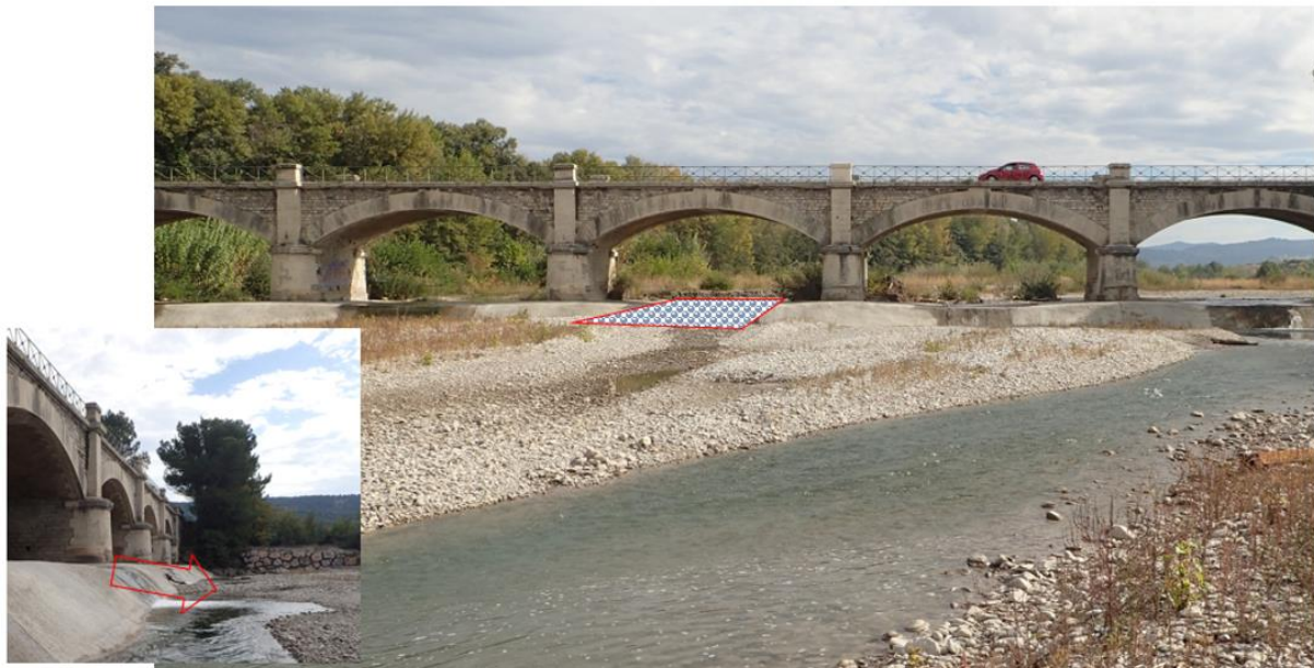
Emplacement de la passe sous l'arche centrale du pont de la RD 20
