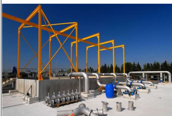
Vue portique membranes
