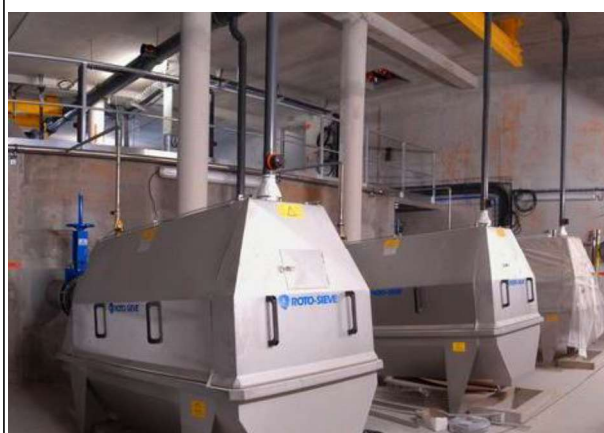
Vue tambours filtrants
