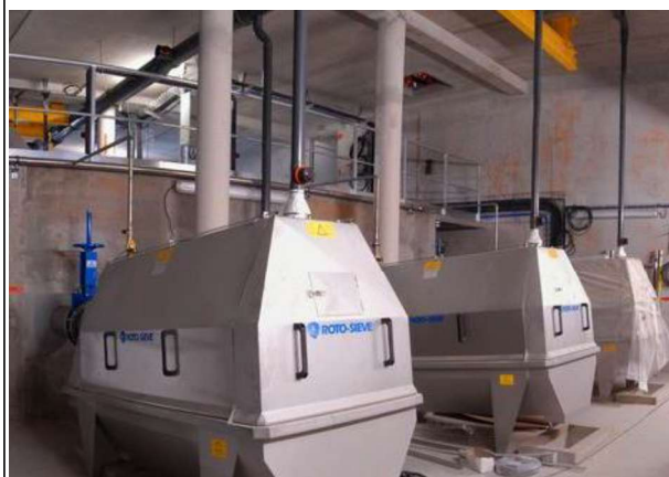
Vue tambours filtrants
