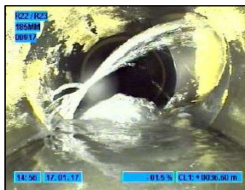
Figure 5 : Photographie d'infiltrations par jaillissement dans le réseau (AXIS 3D 2017)
