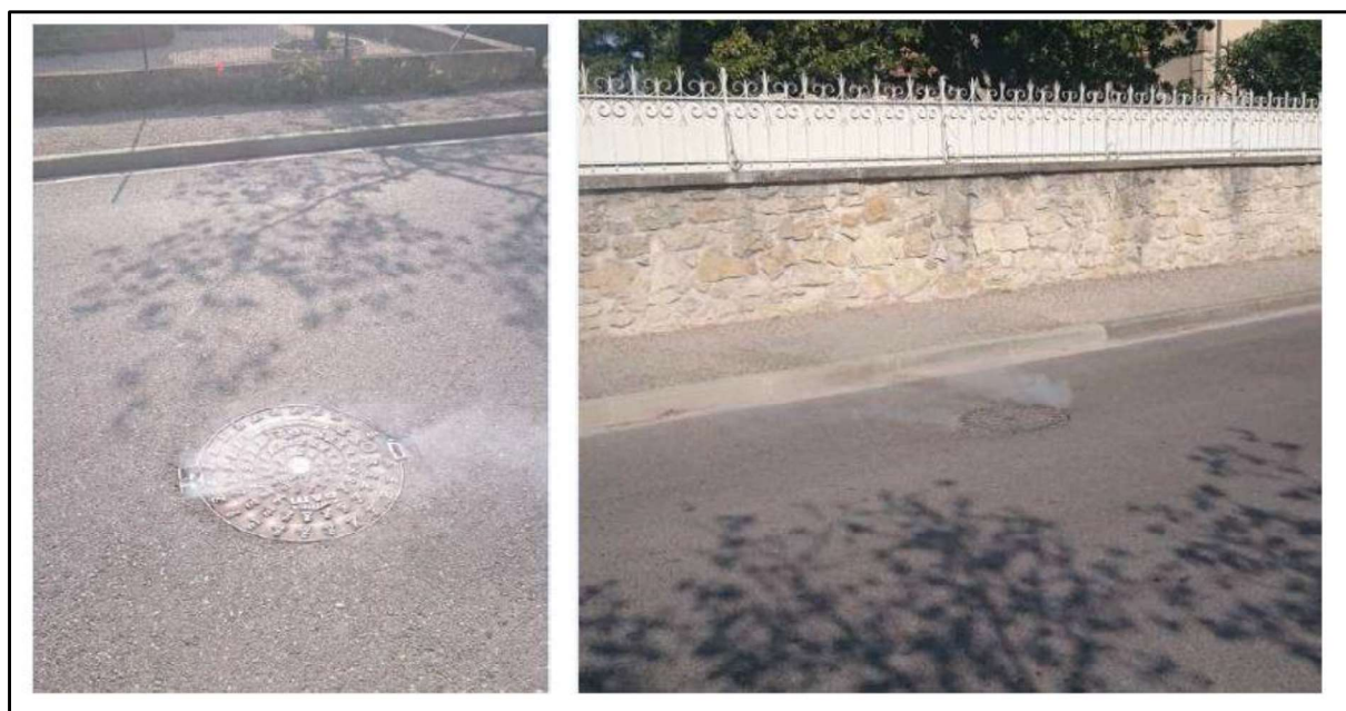
Figure 96 : Exemple de regard non étanche sur le Boulevard d'Althen
