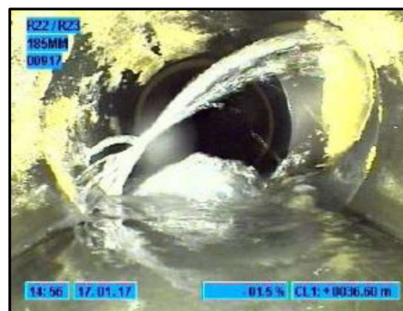
Figure 7 : Photographie d'infiltrations par jaillissement dans le réseau (AXIS 3D 2017)
